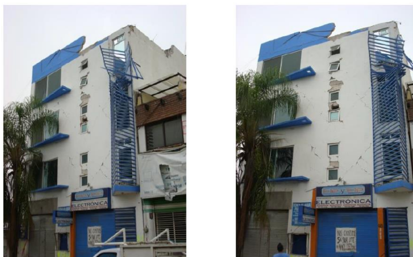
Figura 1.2 - Danos em edifício localizado em Chiapas, México após o sismo de 8,2 M_w em 2017 (Adaptada de GODÍNEZ et al., 2019).
