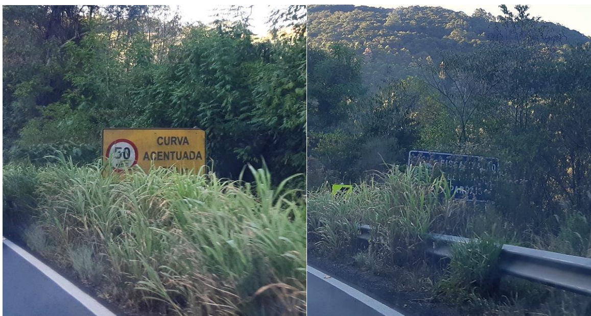
Figura 15 – Sinalizações verticais obstruídas pela vegetação
