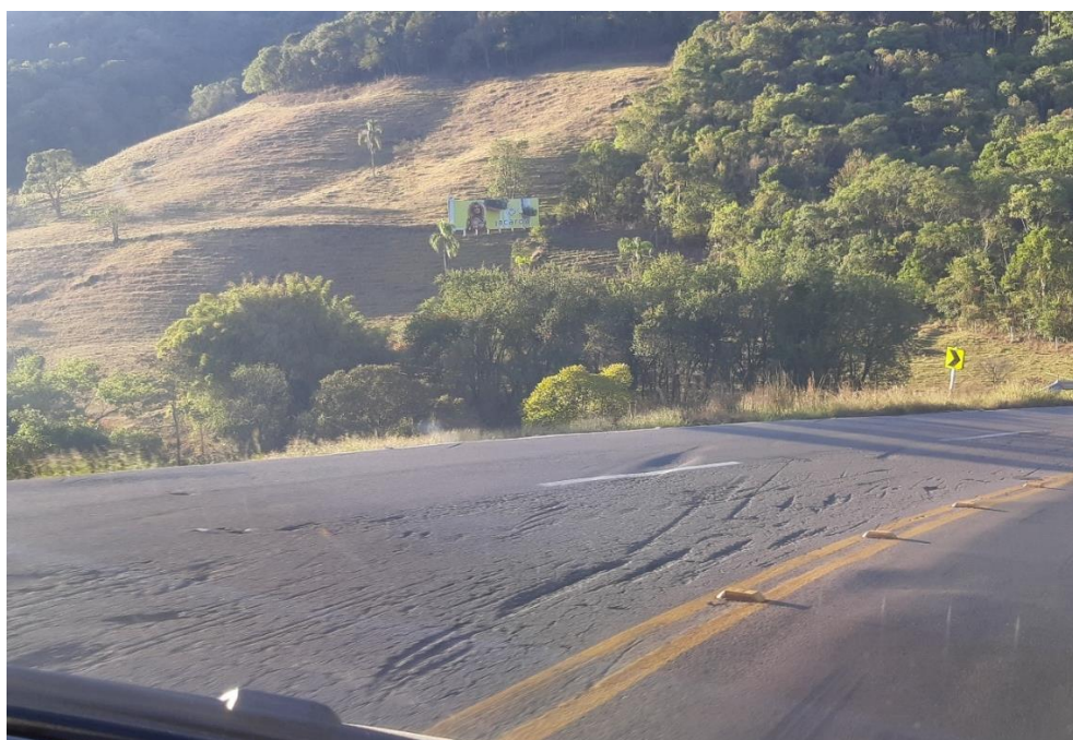
Figura 14 – Cicatrizes no pavimento provocadas por tombamento de veículos
