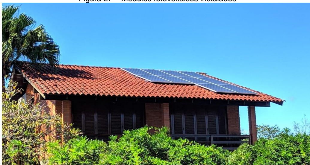
Figura 27 – Módulos fotovoltaicos instalados
