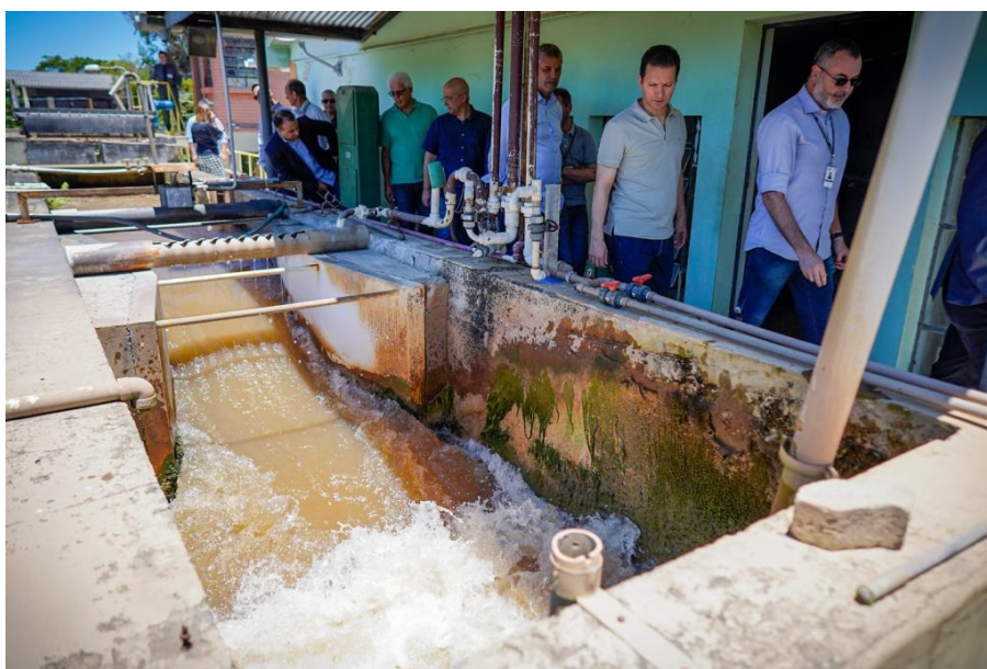
Figura 2.4. Entrada de água bruta na ETA Belém Novo (Porto Alegre) recebendo coagulante e misturando rapidamente.
