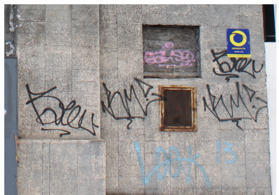
ação de pixação/vandalismo
