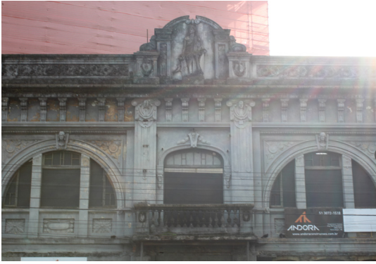
inexistência de vidros (vitrais)
