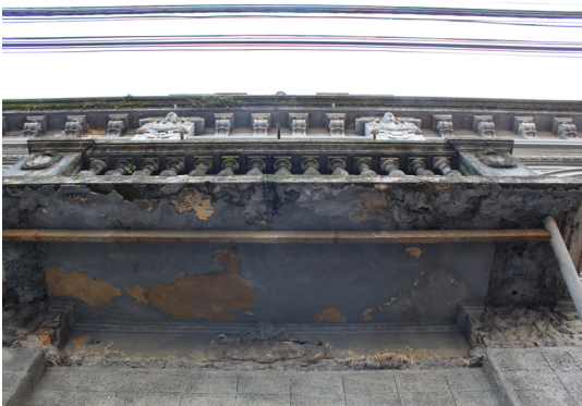
corrosão do metal de reforço estrutural das sacadas originais
