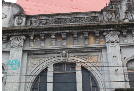
descascamento da pintura
