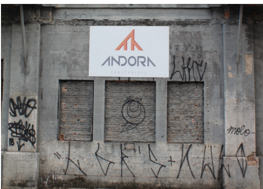
ação de pixação/vandalismo
