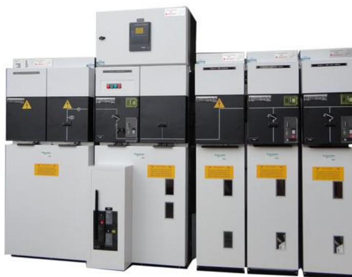
Figura 30 – Exemplo de cubículo de média tensão.
