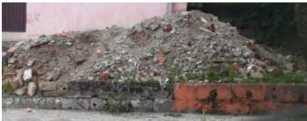
Figura 4: RCD - presença de tijolos, cimento, entre outros
