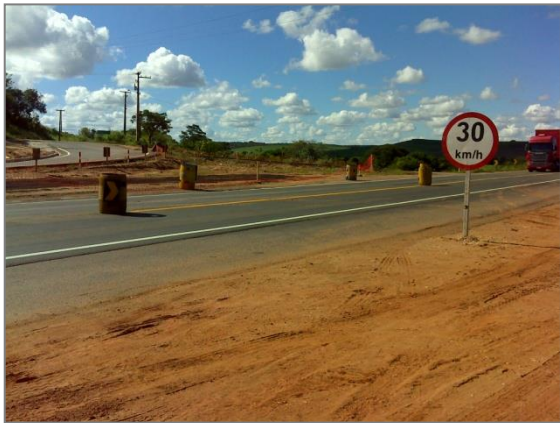
Figura 8 – Sinalização temporária de obra, acesso ao município de Capela, 15/06/2016 Fonte: arquivo pessoal
