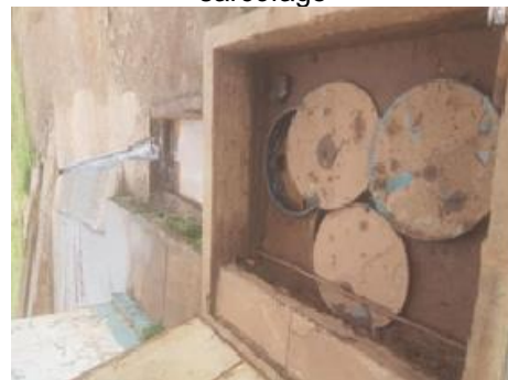
Figura 30 – SAO em fibra de vidro em sarcófago
