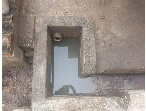
Figura 42 – Canaletas de drenagem da OM 5
