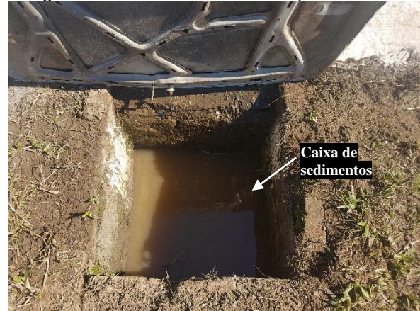
Figura 38 – Caixa de sedimentação da OM 3
