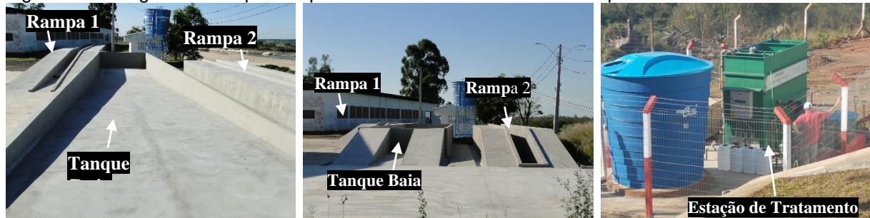
Figura 28 – Imagens da rampa adequada com tratamento de efluentes para o reuso
