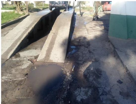
Figura 26 – Estrutura do piso com rachaduras
