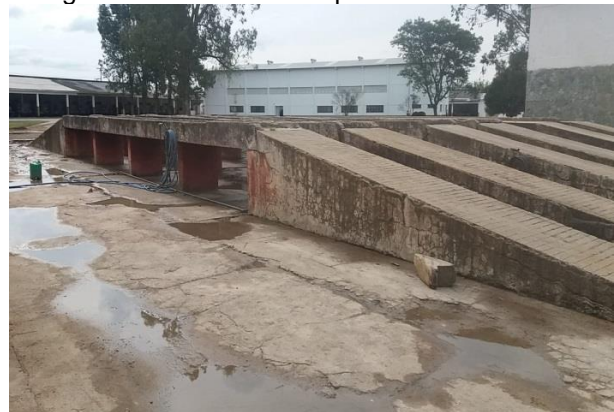
Figura 27 – Estrutura do piso com rachaduras
