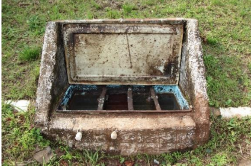
Figura 31 – SAO de Fibra de vidro com proteção
