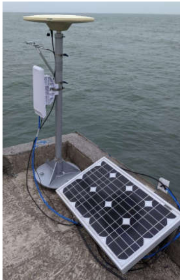
Figura 57: GNSS Geodésico com o mastro curto sobre o marégrafo e o rádio para a internet.
