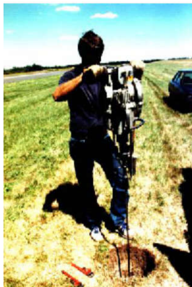
Figura 14: Aterramento da barra de aço inox até sua recusa pelo solo.
