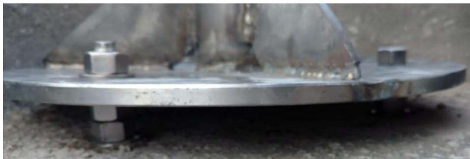
Figura 32: Vista Lateral dos Parafusos de Nivelamento do Pedestal do Mastro.
