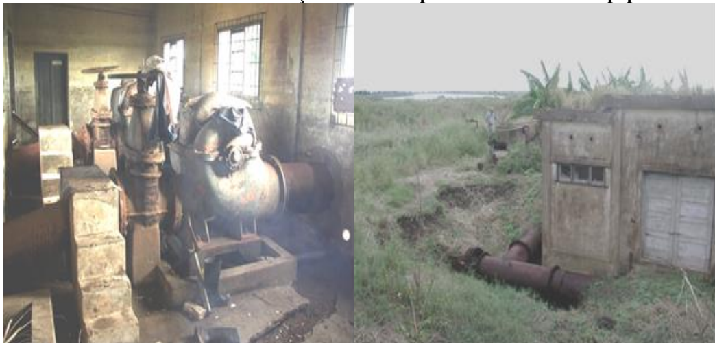
Figura 8 - Estado das infraestruturas e instalações do SRBL após as cheias do rio Limpopo no ano de 2000
