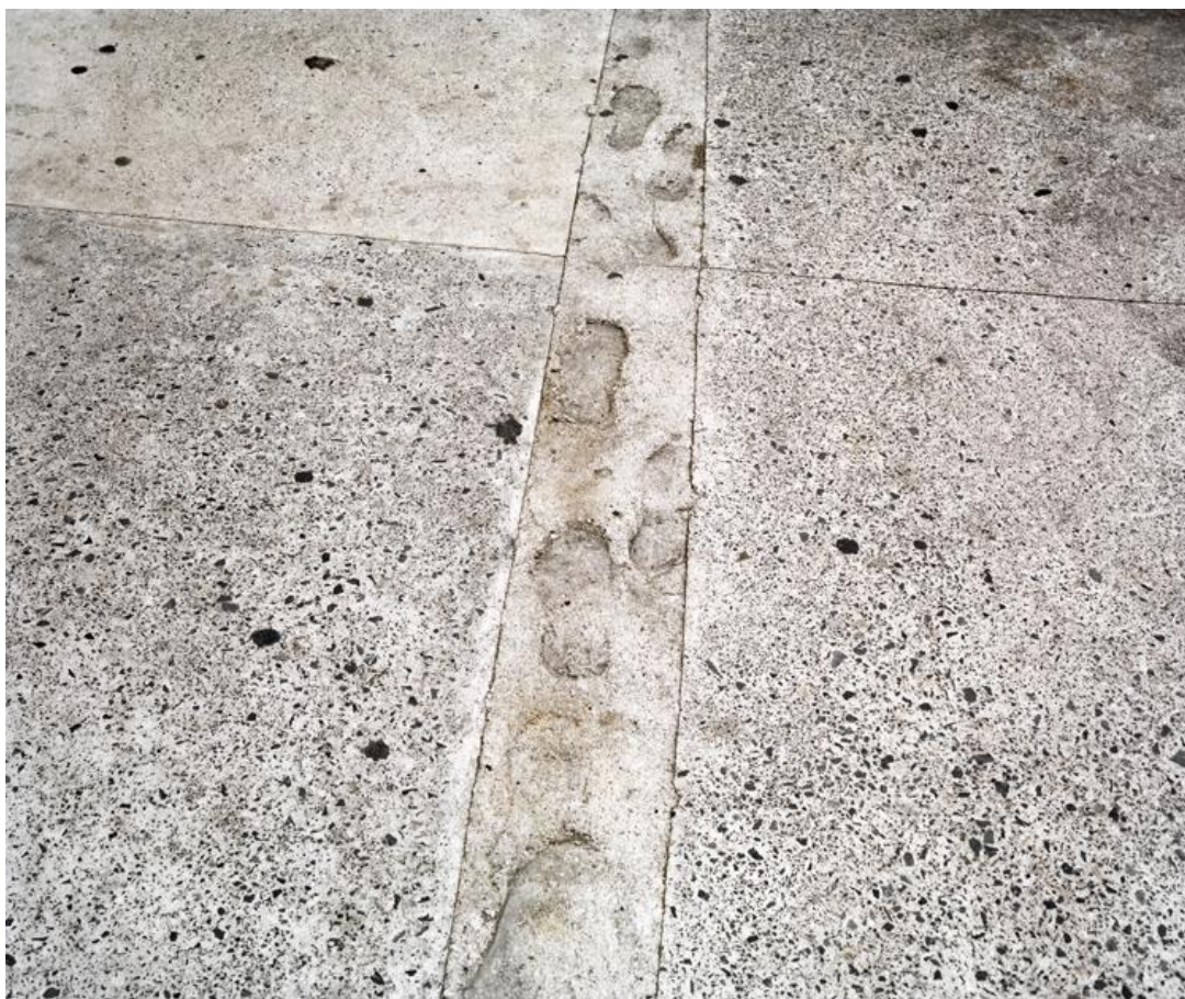
Figura 3 - Foto que registra pegadas no concreto, rastro de uma passagem Fonte: Russo, 2017
