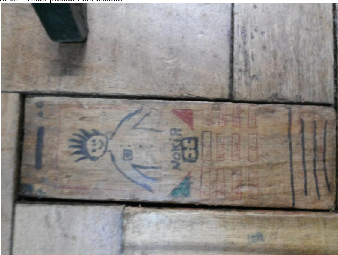
Figura 25 - Chão pichado em escola.
