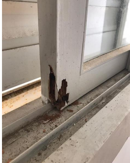
Figura 36 - Janela com infestação de cupins
