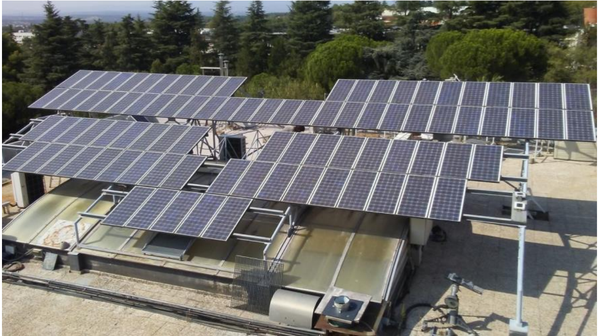
Figura 4.3 Gerador de 7 kWp com 24 anos de operação caracterizado no estudo.
