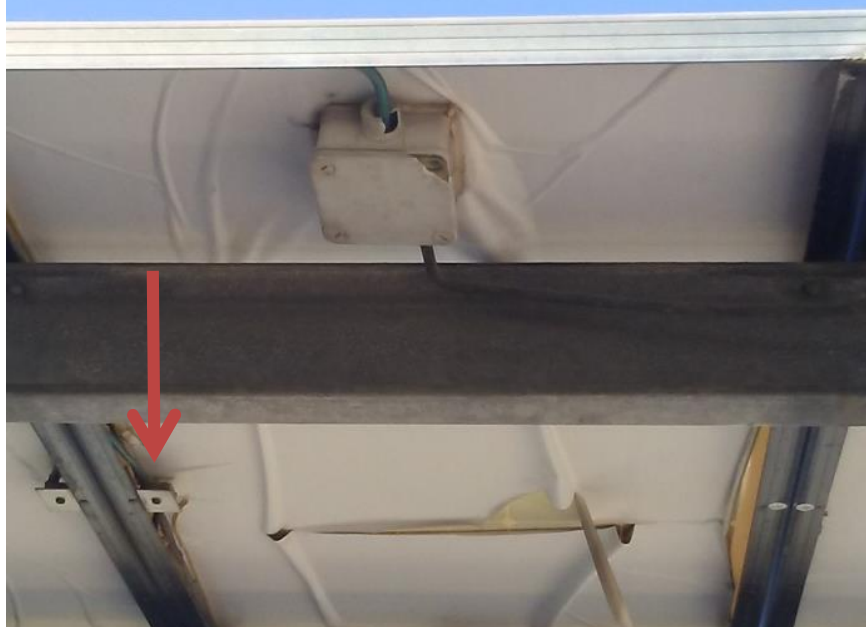
Figura 5.29 Caixa de conexão pouco danificada, indicação do diodo de derivação (pela seta vermelha) além de forte delaminação na área da caixa.
