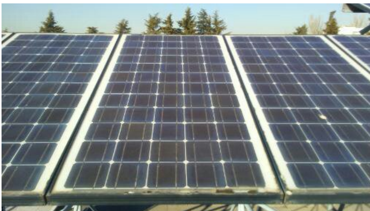
Figura 5.21 Estado geral dos módulos antes da limpeza realizada para caracterização. Observa-se o escurecimento afetando os módulos atuando não homogeneamente sobre as células. No módulo a direita observa-se a sujeira causada por pássaros.
