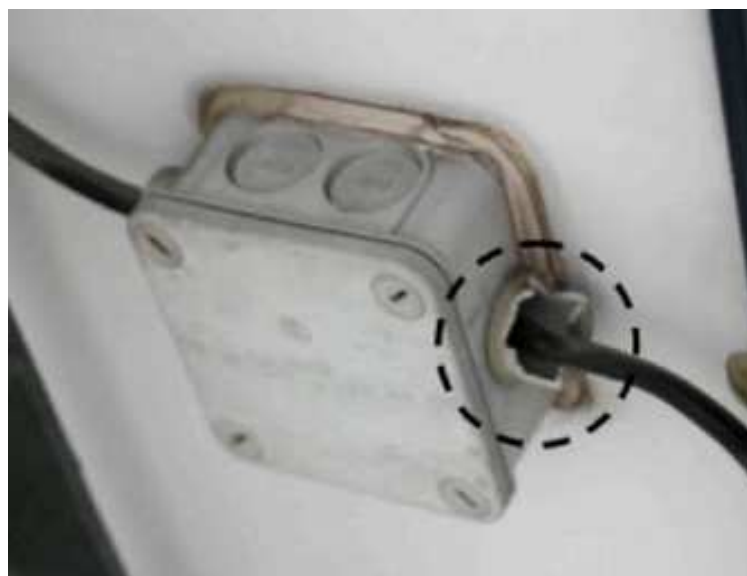
Figura 5.20 Trinca das caixas terminais dos módulos depois de 13 anos de operação (LORENZO et al., 2013).
