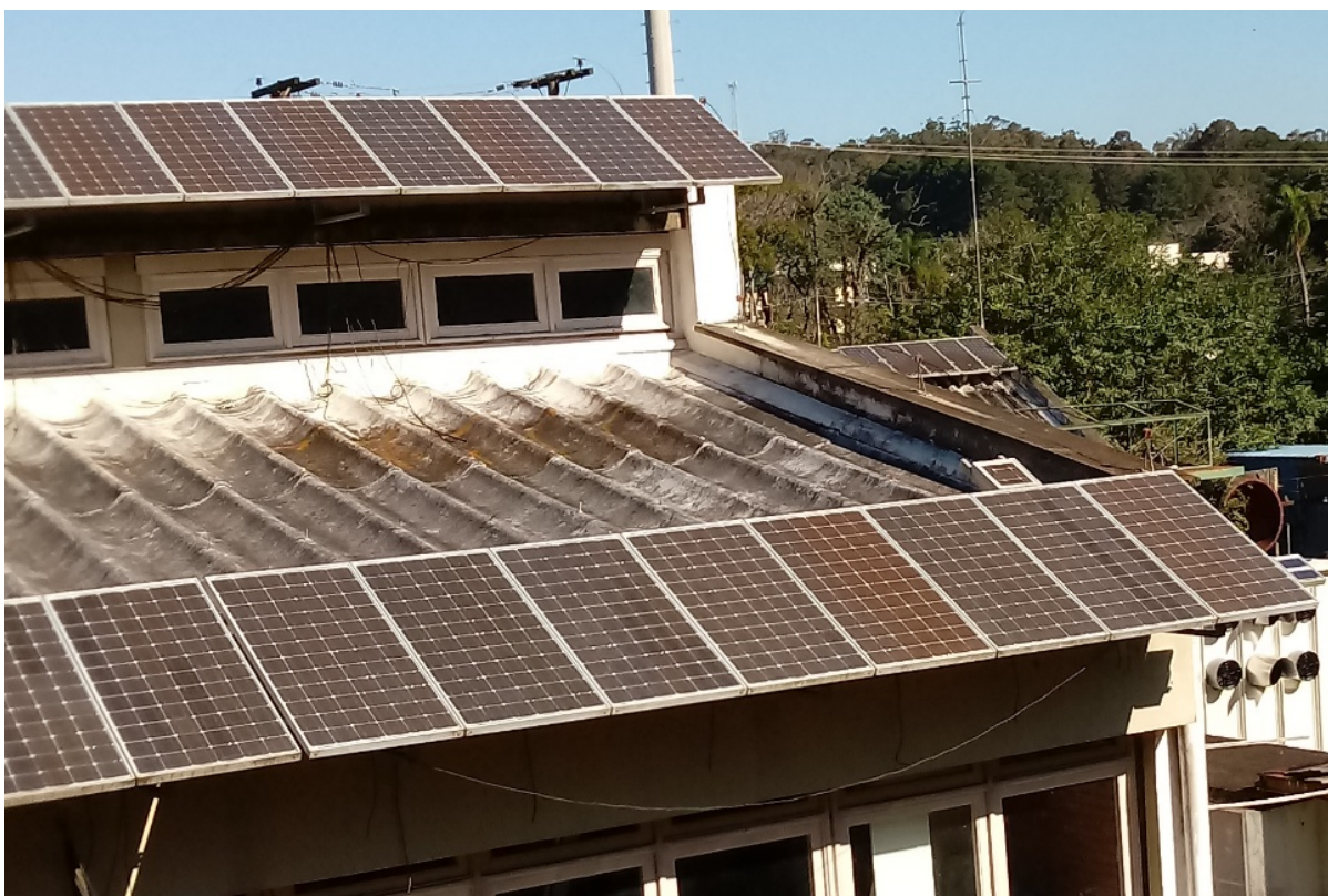
Figura 6.7 Registro da imagem do arranjo oeste no dia da avaliação termográfica.
