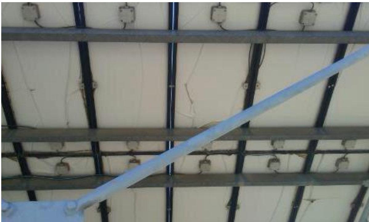
Figura 5.27 Visão posterior geral do gerador.
