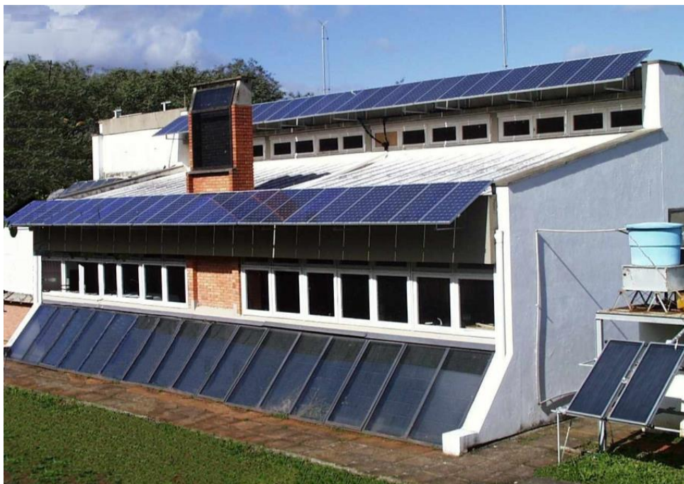
Figura 4.7 Fachada norte do LABSOL mostrando o gerador fotovoltaico de 4,8 kWp.
