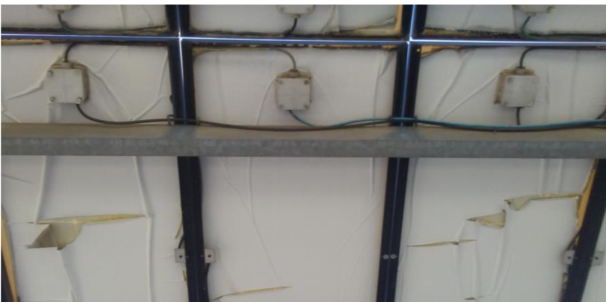
Figura 5.28 Módulos apresentando delaminação posterior grave.
