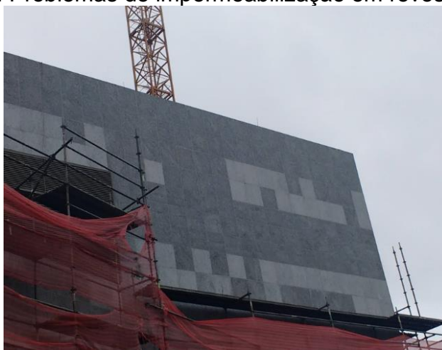
Foto 8: Problemas de impermeabilização em revestimento
