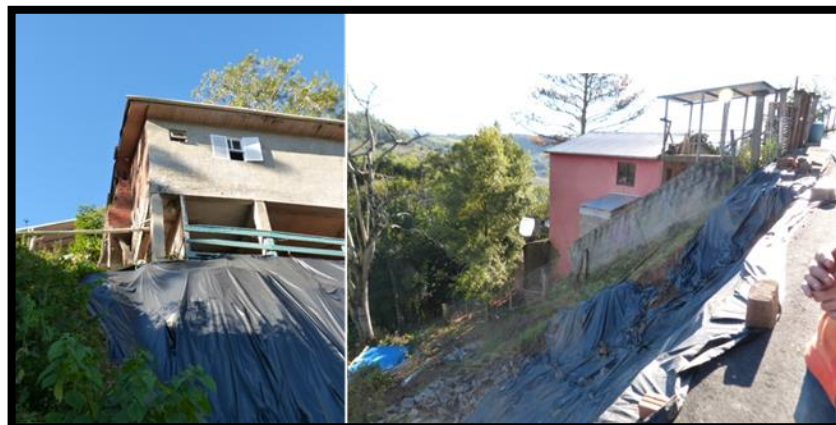
Figura 3.13 – Porção superior do escorregamento e porção inferior do escorregamento, registro de campo.
