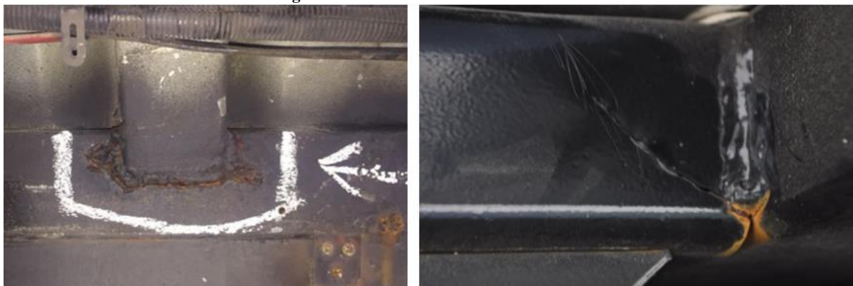
Figura 2.20 - Falha em estrutura de ônibus
