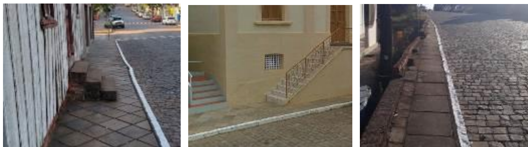
Figura 22 – Imagens de casos de inacessibilidade: larguras de passagem insuficiente
