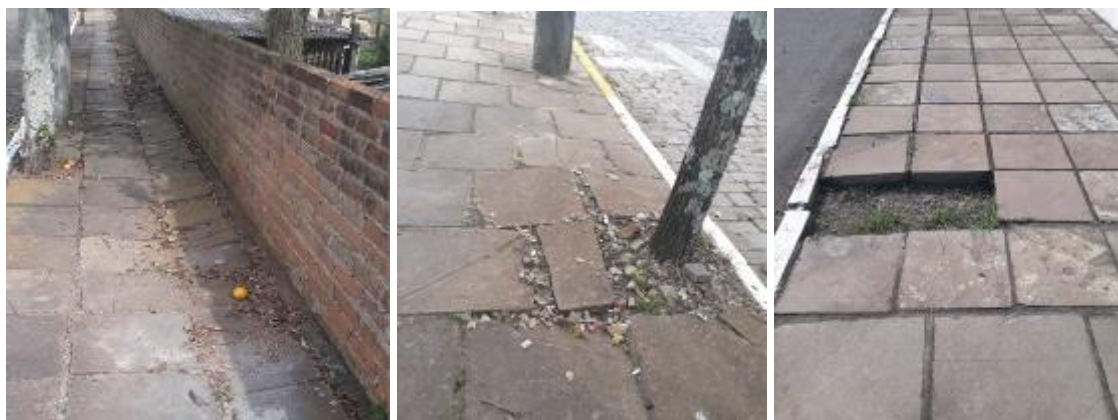
Figura 29 – Imagens de irregularidades nas calçadas
