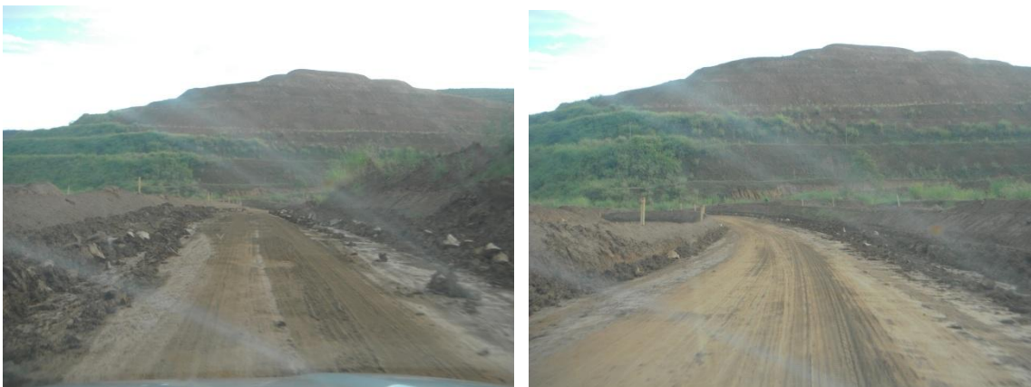
Figura 31. Bermas com acúmulo de água e movimentação de material para pista.
