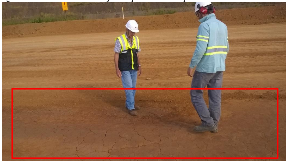
Figura 37. Rachaduras couro de jacaré que evidenciam problemas estruturais da estrada
