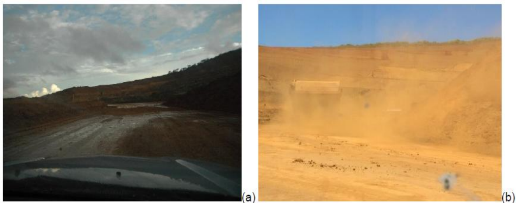
Figura 40. Exemplos de defeitos funcionais rodoviários durante as estações chuvosa (a) e seca (b).
