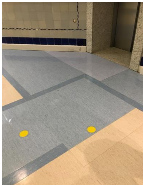
Figura 29: Peça de revestimento de piso vinílico que foi trocado e não se manteve no mesmo desenho que o original
