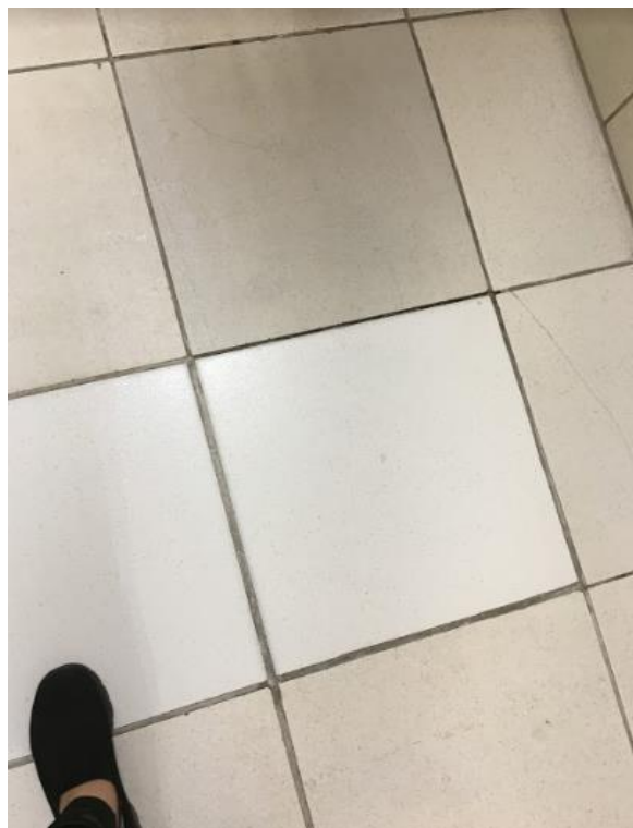
Figura 78: Revestimento de piso cerâmico comprado após a compra do revestimento utilizado anteriormente
