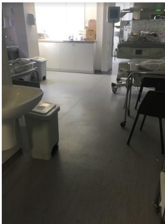
Figura 50: Revestimento de piso vinílico em manta utilizado em área de serviço de saúde
