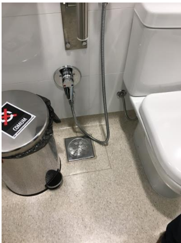
Figura 25: Ralo do banheiro em contato com revestimento de piso vinílico.
