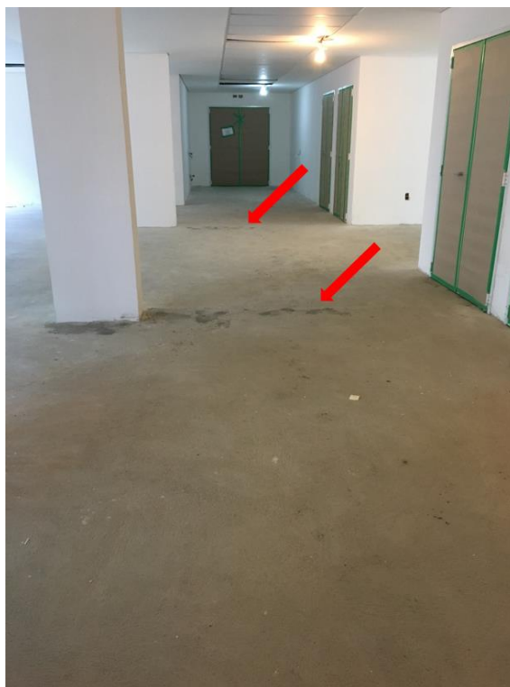
Figura 69: Preenchimento das fissuras com resina sintética nos locais que deveriam receber junta de movimentação no contrapiso
