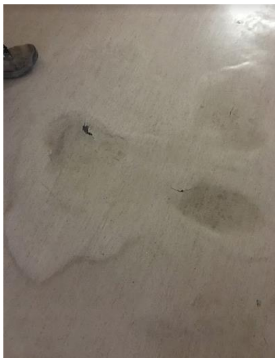
Figura 60: Revestimento de piso vinílico em manta deteriorado em uma das áreas do piso
