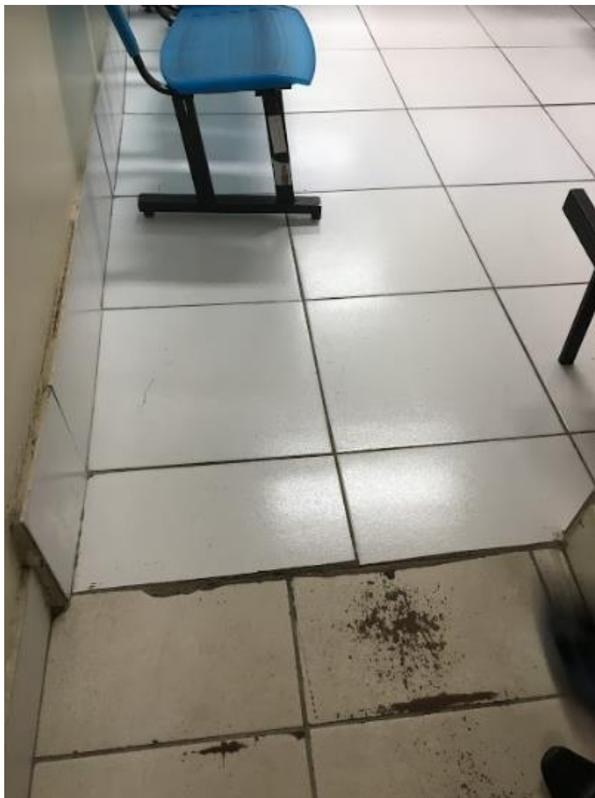
Figura 77: Revestimento de piso cerâmico comprado muito depois da compra do revestimento utilizado originalmente
