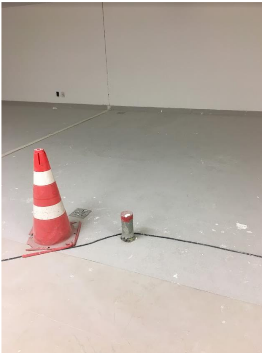
Figura 42: Encontro de revestimentos vinílico e cerâmico na sala de expurgo
