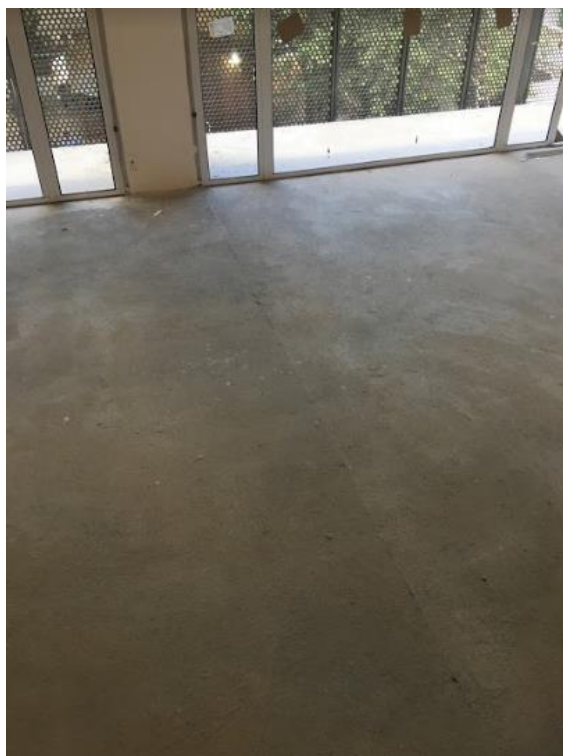
Figura 68: Junta de movimentação no contrapiso
