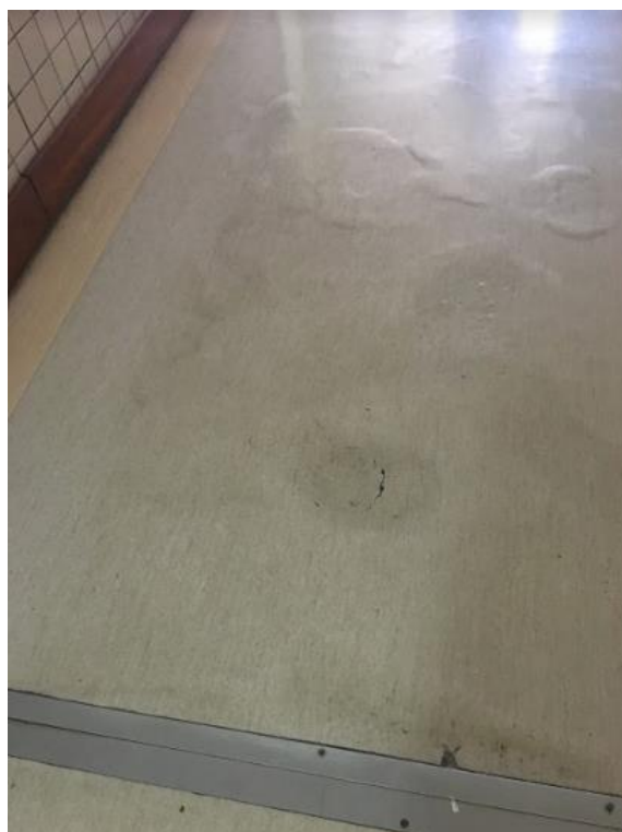
Figura 58: Revestimento de piso vinílico em manta deteriorado em uma das partes do piso
