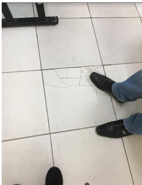
Figura 79: Revestimento de piso cerâmico que demanda manutenção
