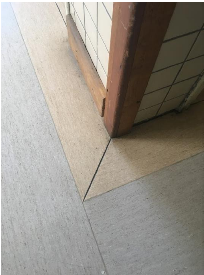
Figura 55: Trecho com inexistência de rodapé e trecho com rodapé em madeira na circulação
