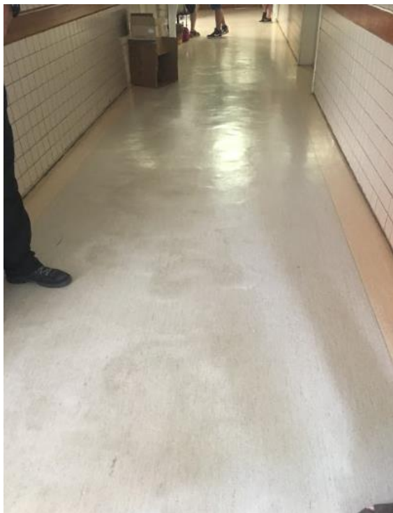
Figura 59: Revestimento de piso vinílico em manta deteriorado em uma das partes do piso
