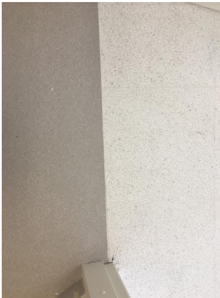
Figura 46: Junta no encontro dos revestimentos de piso vinílico utilizados na circulação e na sala de cirurgia
