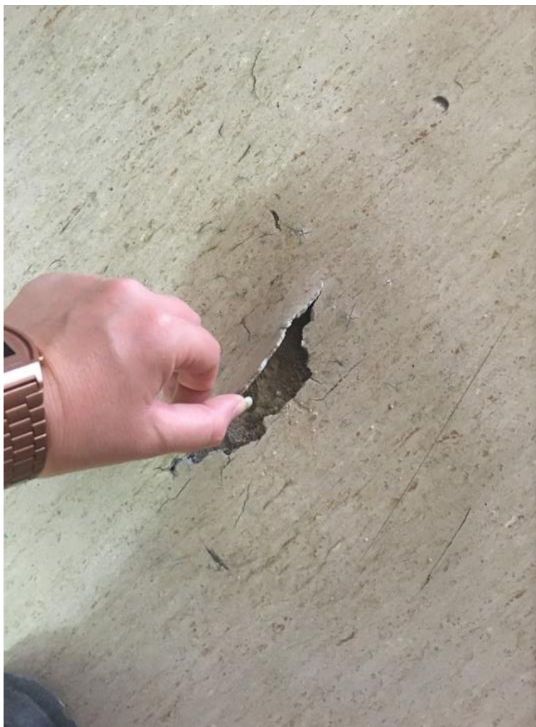
Figura 61: Bolha aberta em revestimento de piso vinílico em manta
