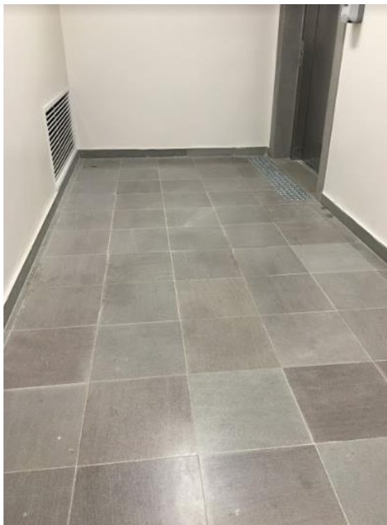
Figura 10: Revestimento de piso em basalto utilizado no acesso ao elevador de serviço
