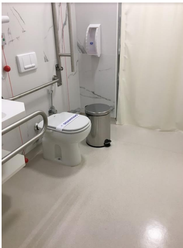
Figura 20: Revestimento de piso vinílico em banheiro de paciente
