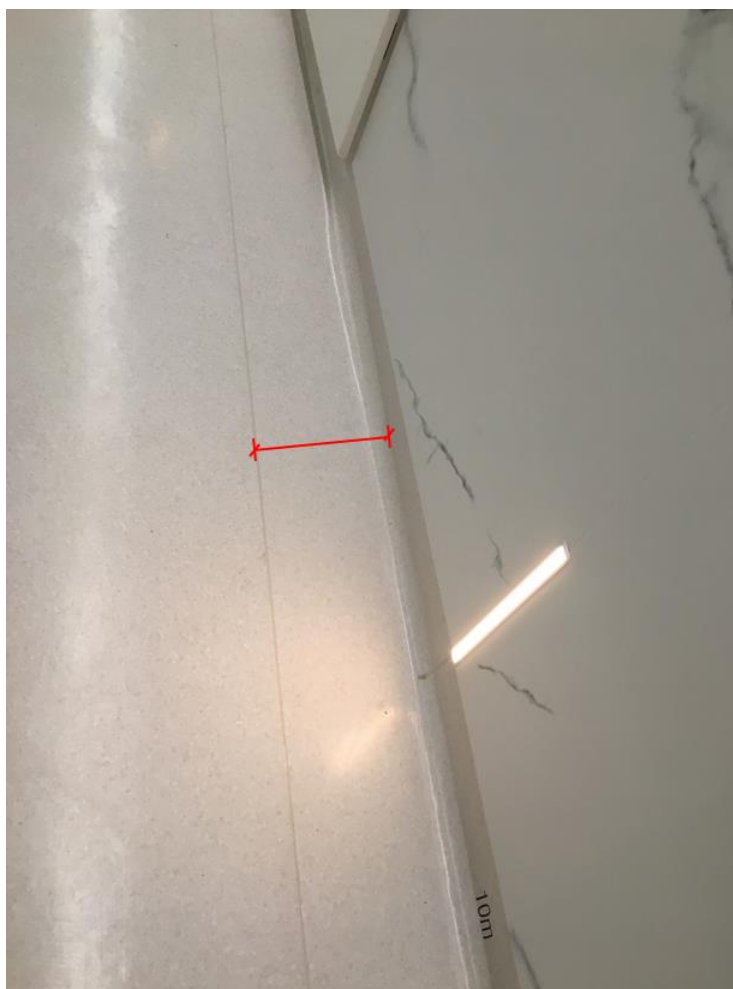
Figura 27: Rodapé com extensão a partir da parede maior do que utilizada anteriormente
