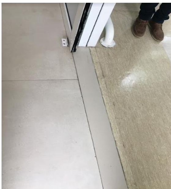
Figura 32: Junta inevitável no encontro de tipos diferentes de revestimento de piso
