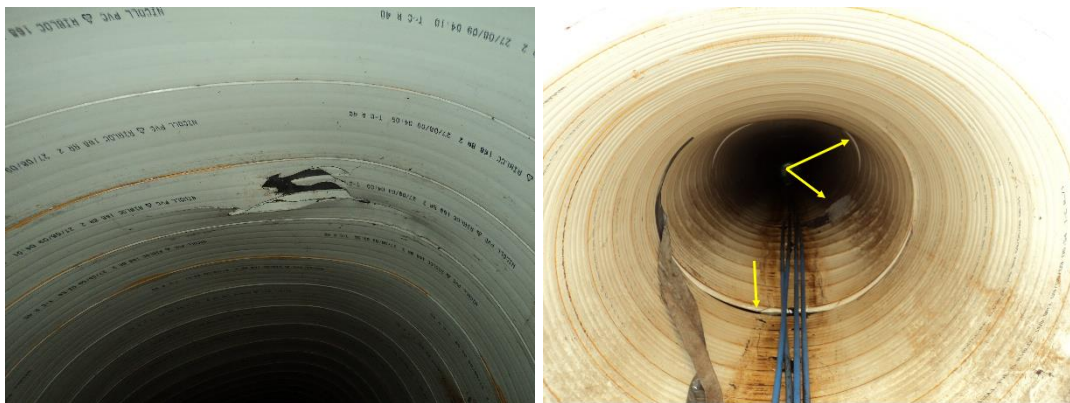
Figura 7: Danificações observadas no bueiro
