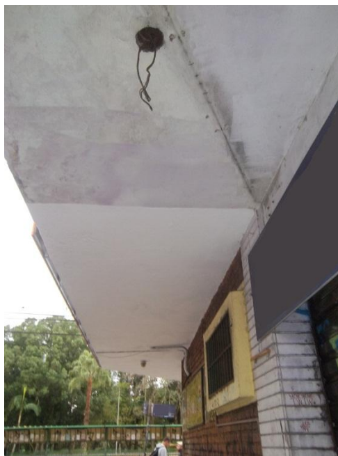
Figura 80 – Diferença de aspecto entre as partes devido à repinturas
