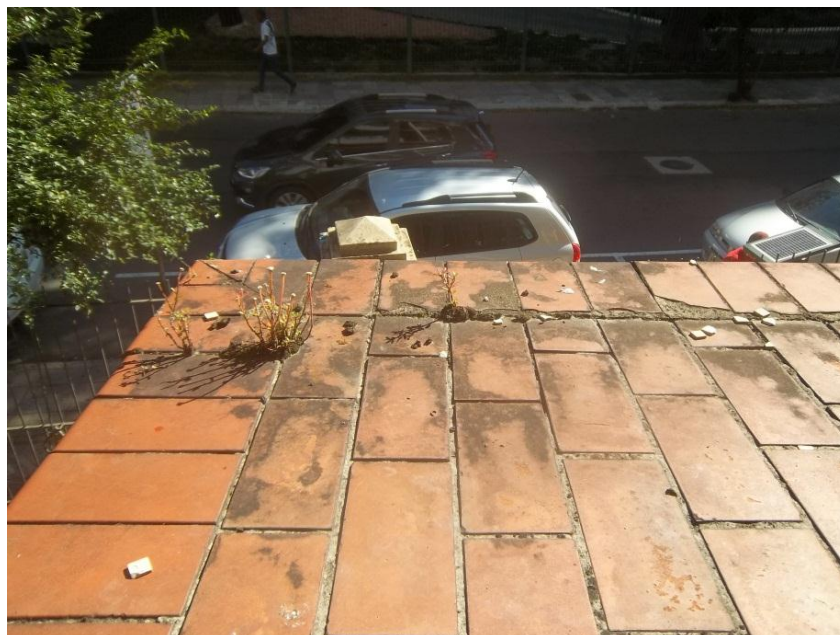
Figura 93 – Crescimento de vegetais por entre os rejuntas
