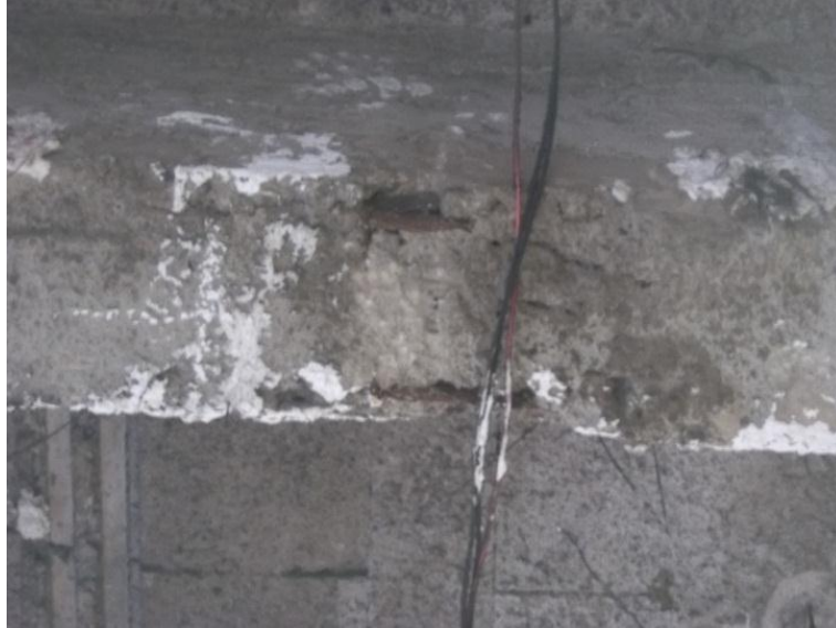
Figura 32 – Armaduras expostas e corroídas na viga V5
