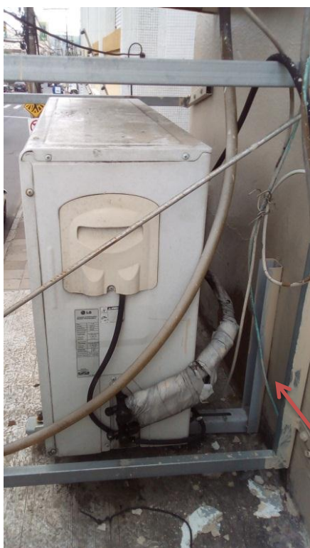
Figura 82 – Ar condicionado fixado na fachada da edificação
