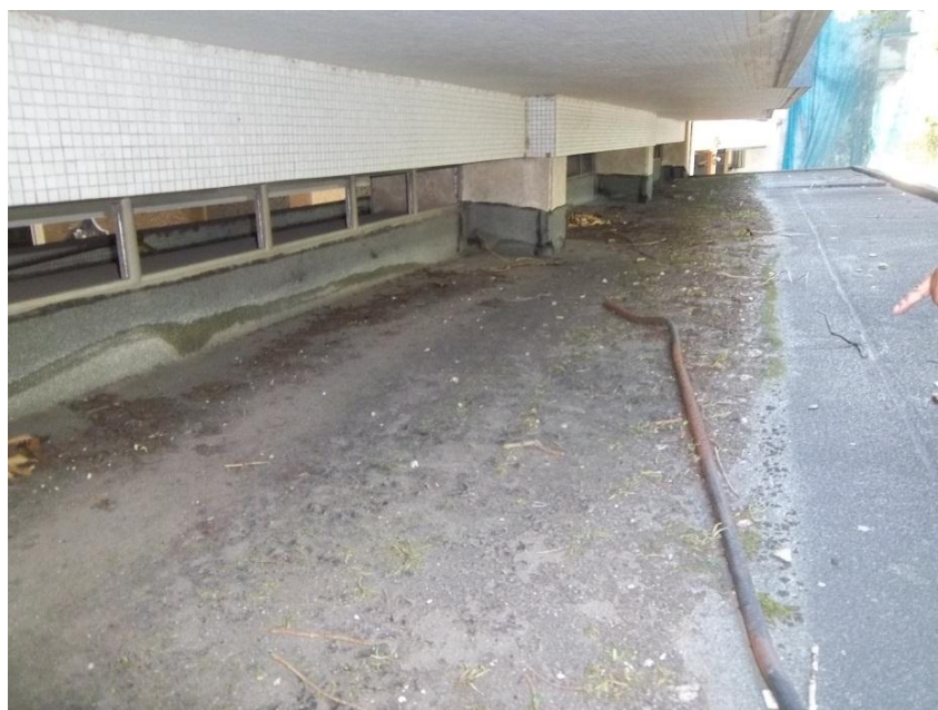
Figura 119 – Restos de material e sedimentos na marquise 4
