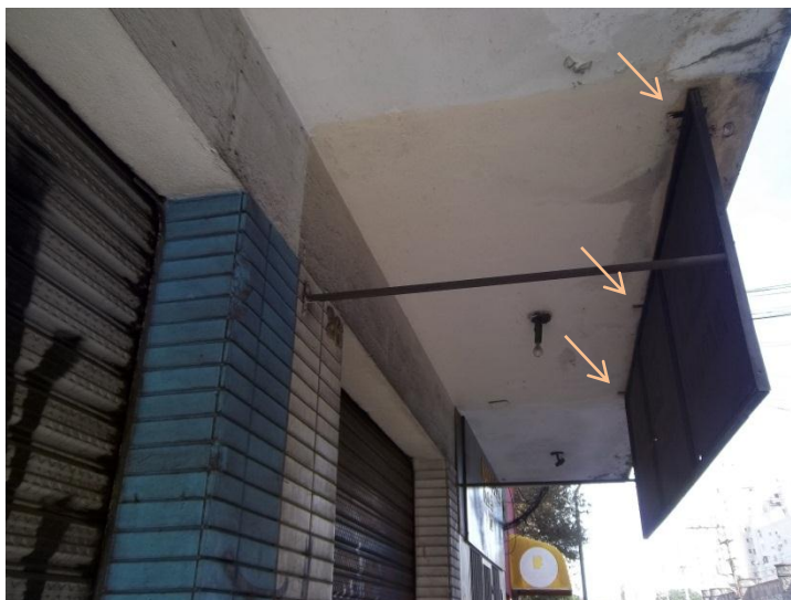
Figura 70 – Sobrecarga devido à fixação de letreiro na marquise
