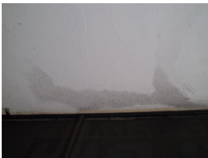
Figura 71 – Manchamento por umidade na região B
