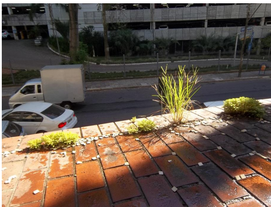
Figura 92 – Presença de vegetação na marquise da Escola de Engenharia da UFRGS
