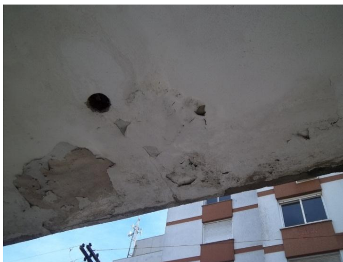
Figura 73 – Bolhas e descascamento da pintura
