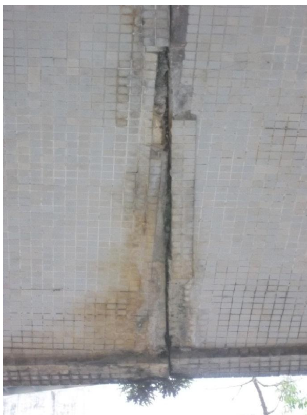
Figura 97 – Remendos ao redor da dilatação na parte inferior da marquise 1
