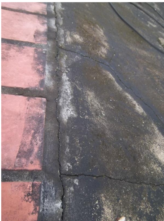
Figura 62 – Fissuras encontradas na região D
