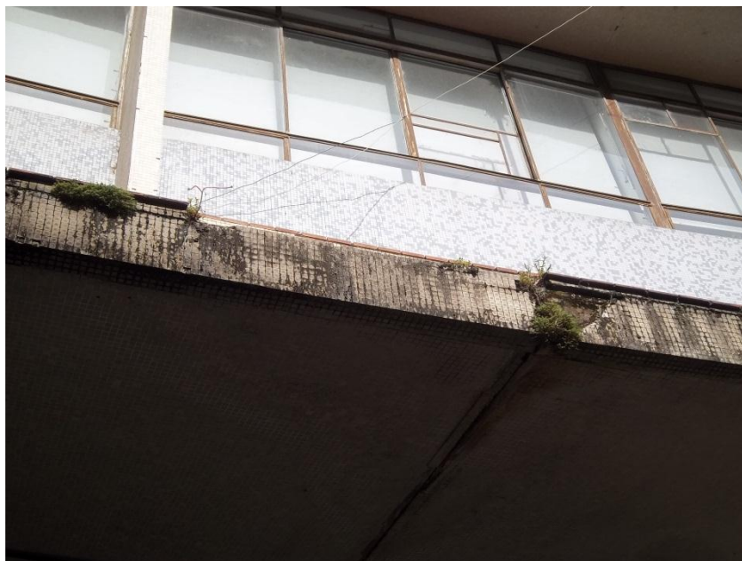
Figura 106 – Placas cerâmicas soltas (vista inferior) e presença de vegetação e manchas de umidade na dilatação
