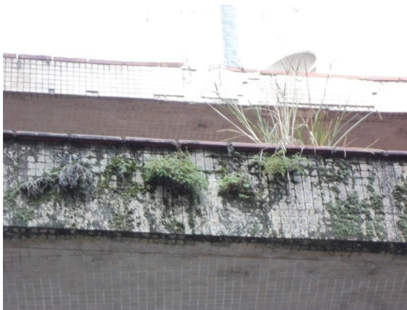
Figura 96 – Vegetação, mofo e bolor no espelho da marquise
