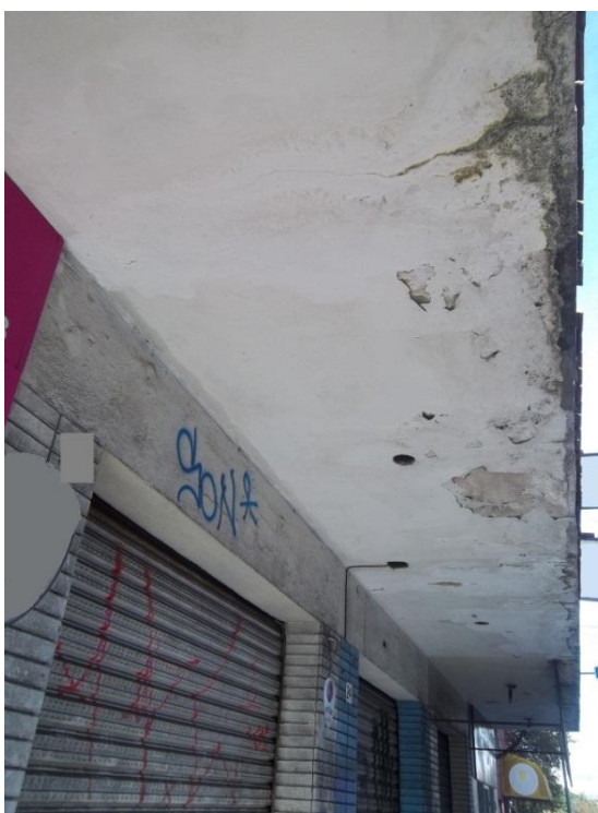
Figura 72 – Fissuração, manchamento e iminente deslocamento do concreto no bordo livre
