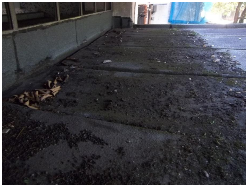
Figura 118 – Sujeira encontrada na região acima das partes vazadas da marquise
