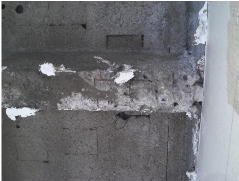
Figura 30 – Armaduras Expostas e restos de forro na viga V2
