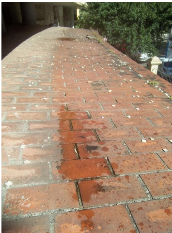
Figura 90 – Mancha de água devido ao gotejamento dos drenos de ar condicionado
