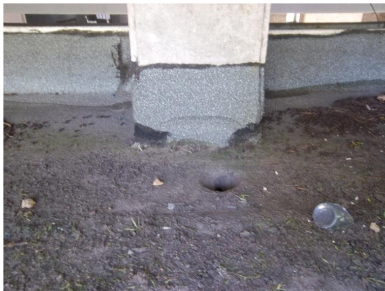
Figura 120 – Detalhe dos dutos de escoamento e acúmulo de sujidades
