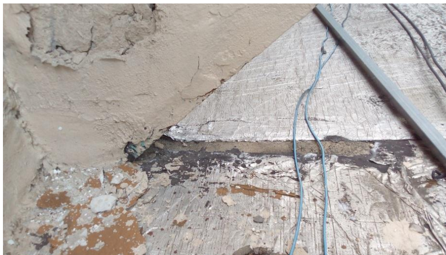
Figura 67 – Parte sem manta asfáltica na região E
