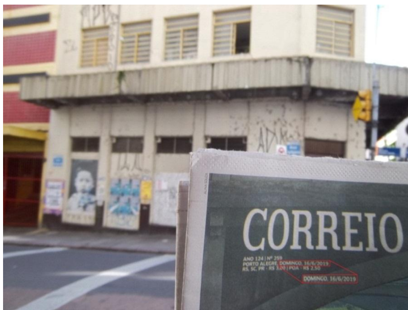
Figura 23 – Comprovação da data da última inspeção na marquise 1
