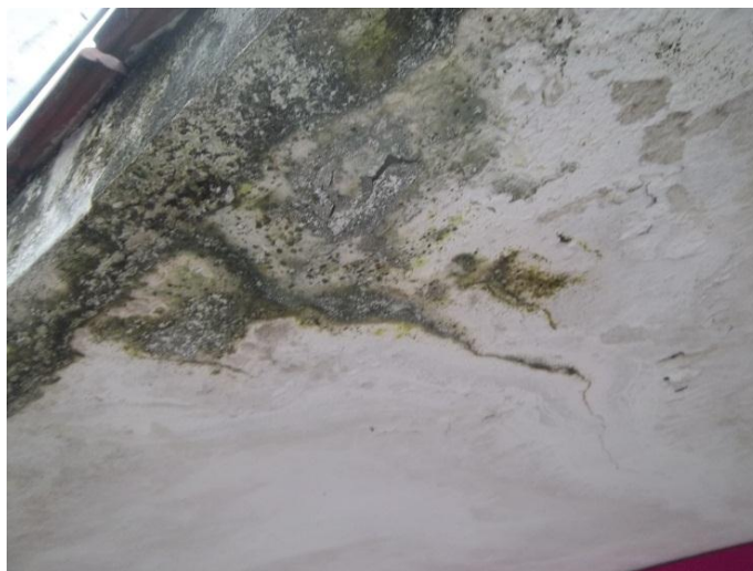
Figura 75 – Detalhe para fissura e acúmulo de mofo e bolor devido à umidade
