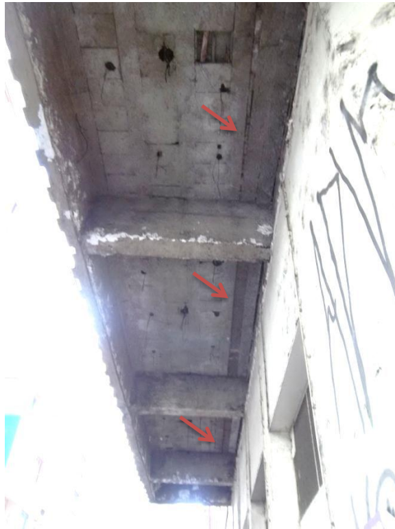
Figura 38 – Imagem das lajes L13 a L16 com linha de vigotas quebradas (indicado por setas) e vigas V14 a V17
