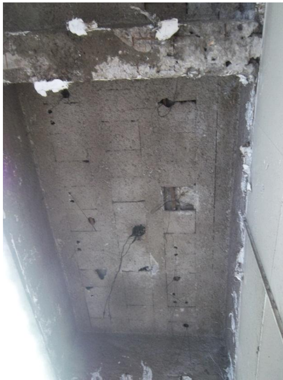
Figura 31 – Buracos na laje e tavela quebrada na laje L2
