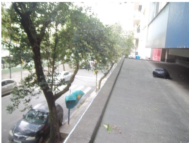
Figura 125 – Proximidade de árvores de grande porte na marquise
