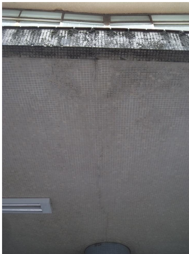
Figura 99 – Manchas de umidade ao redor da fissura na parte inferior da marquise 1
