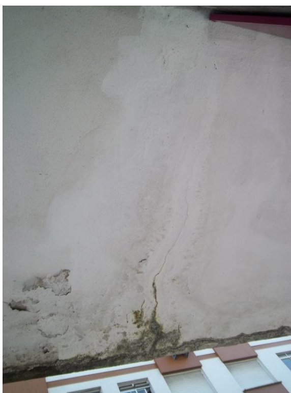
Figura 74 – Fissura transversal e mancha de umidade ao redor
