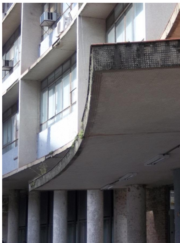
Figura 100 – Bordos escurecidos por umidade e mofo na marquise 1
