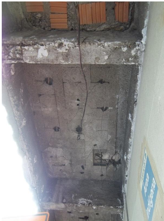
Figura 35 – Buracos, vigota e tavela quebrada na laje L6
