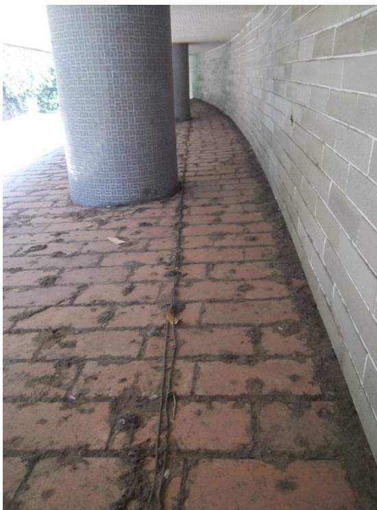
Figura 104 – Acúmulo de fiação elétrica e sujidades
