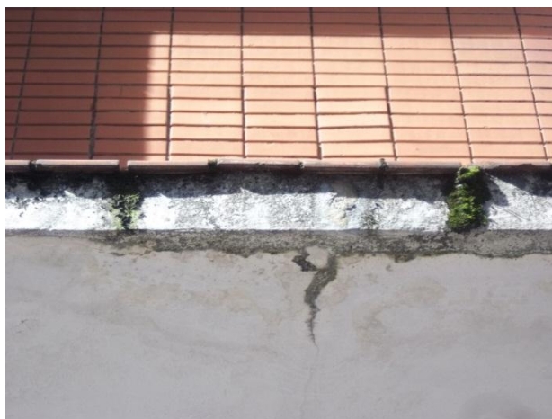
Figura 77 – Detalhe para fissuração e presença de mofo e bolor no bordo
