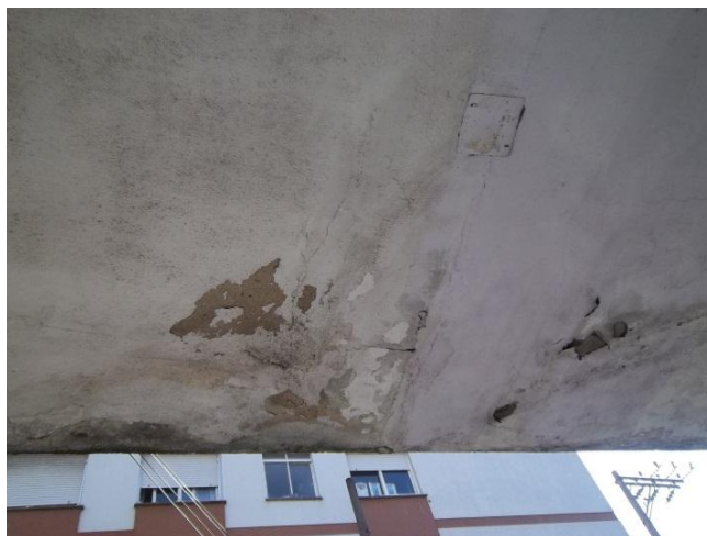
Figura 78 – Manchas de umidade, bolhas e descascamento da pintura na região E
