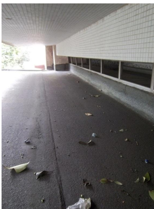
Figura 126 – Ocorrência de folhas, sementes e outras sujidades trazidas pelo vento ou provenientes de queda da fachada do edifício
