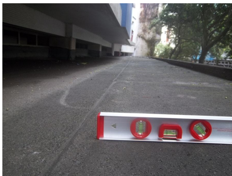
Figura 111 – Caimento acentuado da marquise 4 representado por nível de bolha
