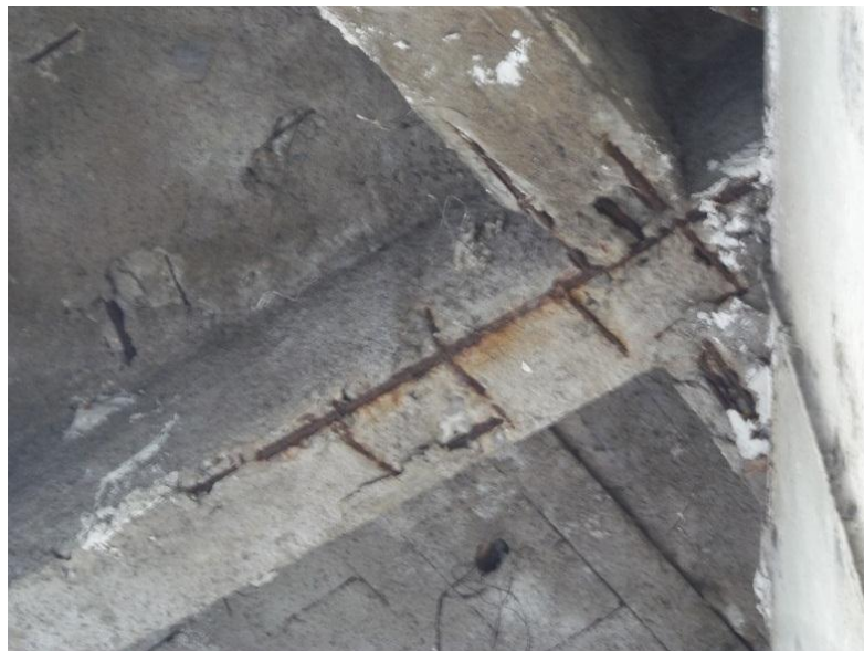
Figura 37 – Armaduras expostas e corroídas nos encontros das vigas V11 e V13
