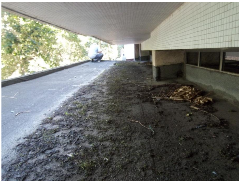
Figura 116 – Depósito de sedimentos na marquise 4 coincide com o alinhamento da fachada do edifício
