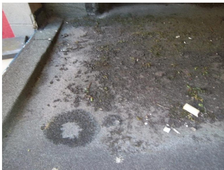
Figura 121 – Detalhe do acúmulo de folhas, sementes e outros detritos
