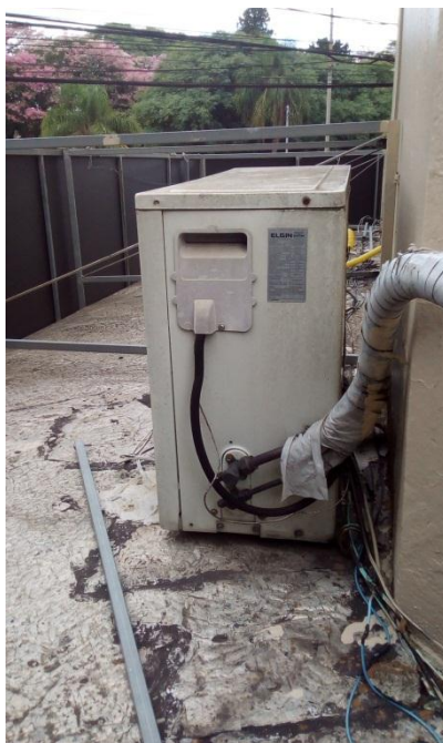
Figura 83 – Ar condicionado apoiado diretamente sobre a marquise
