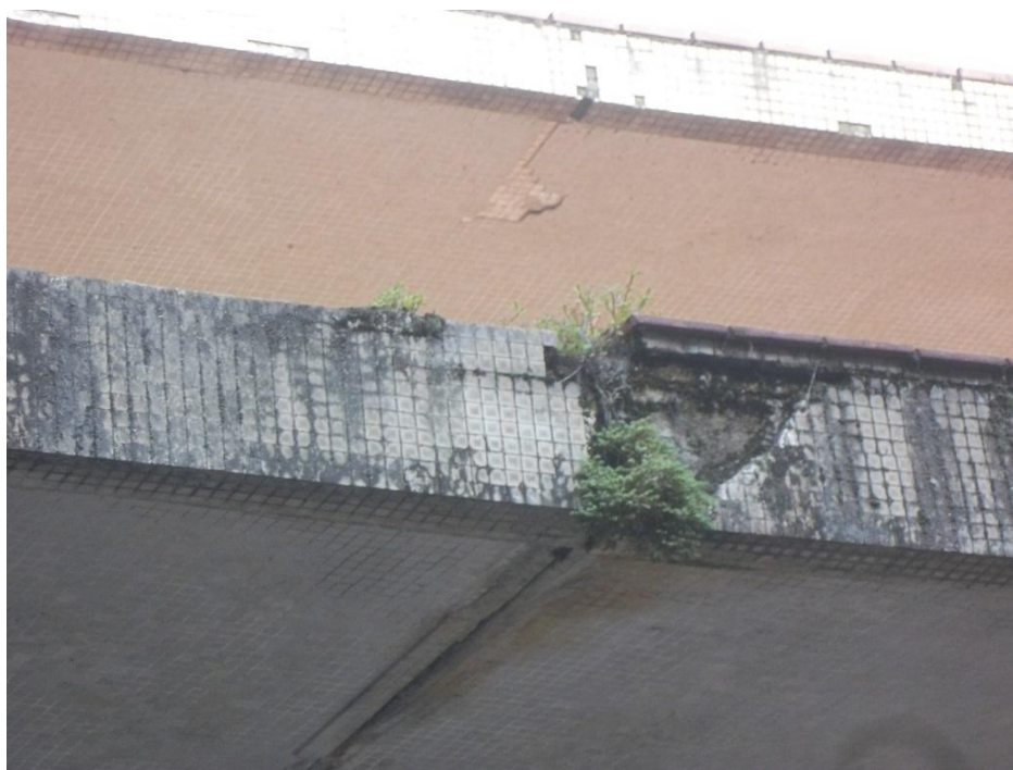
Figura 98 – Presença de vegetação na junta de dilatação
