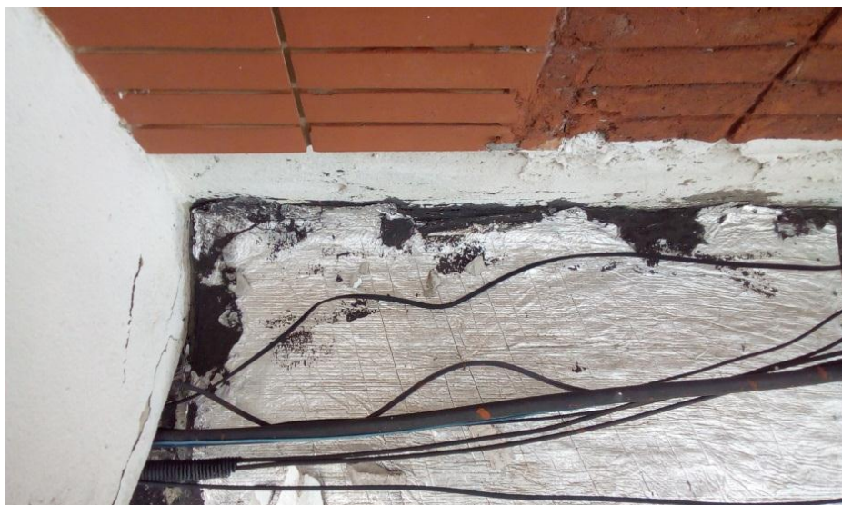
Figura 66 – Descolamento da manta com engaste na região E
