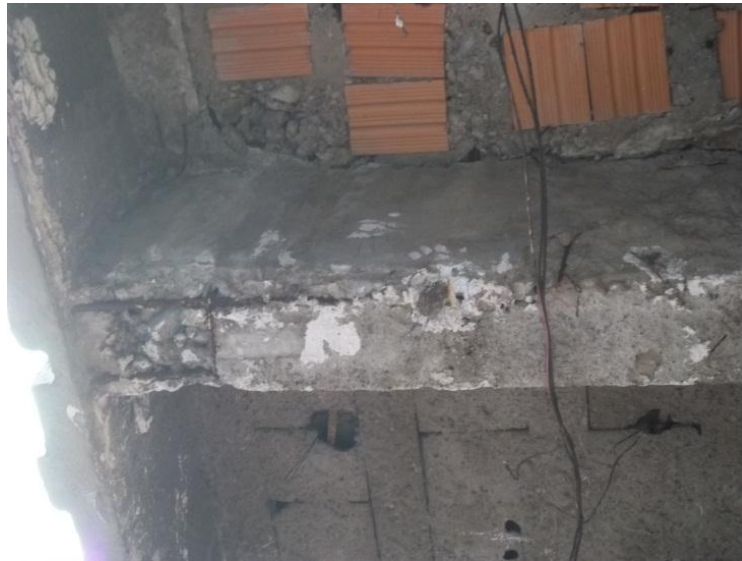
Figura 34 – Armaduras expostas e corroídas na viga V6
