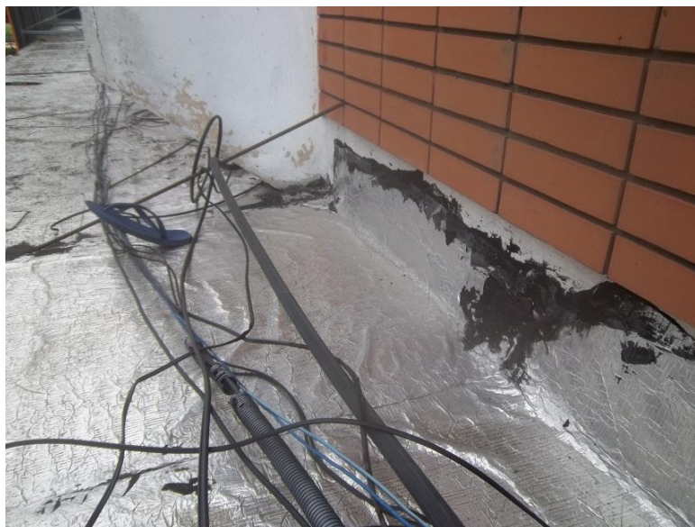
Figura 65 – Rodapé sem proteção na região E
