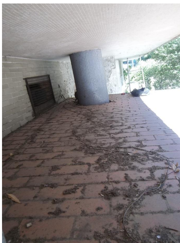
Figura 103 – Fiação elétrica depositada e ocorrência de sujidades
