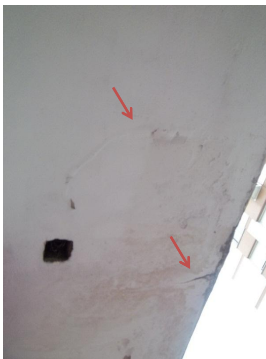
Figura 79 – Bolhas na pintura, fissuração e concreto degradado junto ao bordo
