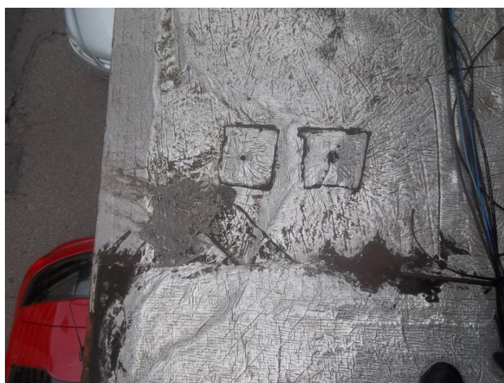
Figura 68 – Corpo estranho sob a manta asfáltica
