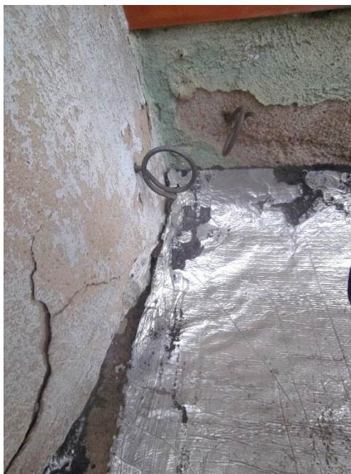
Figura 59 – Descolamento da manta junto ao engaste na região C
