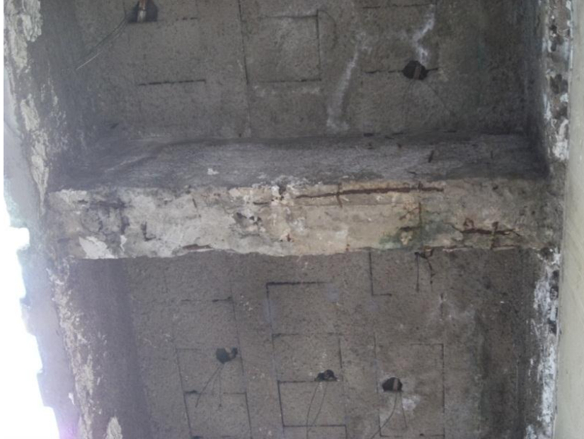
Figura 36 – Armaduras expostas e corroídas na viga V9
