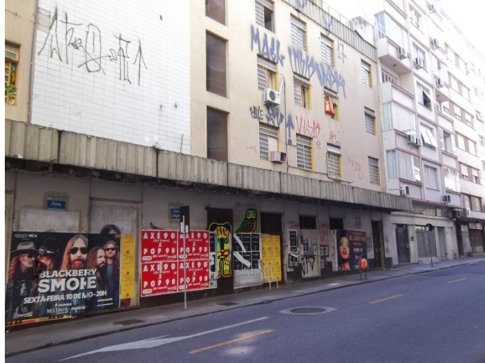
Figura 26 – Fachada da edificação com ênfase para a marquise nº1
