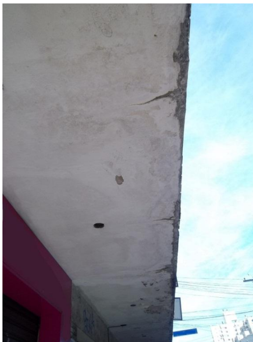
Figura 76 – Fissuração, manchamento e concreto degradado no bordo livre da região D
