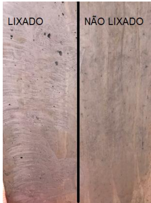
Figura 14 – Comparação entre concreto lixado (à esquerda) e concreto não lixado (à direita), painel 3 – pilar 23
