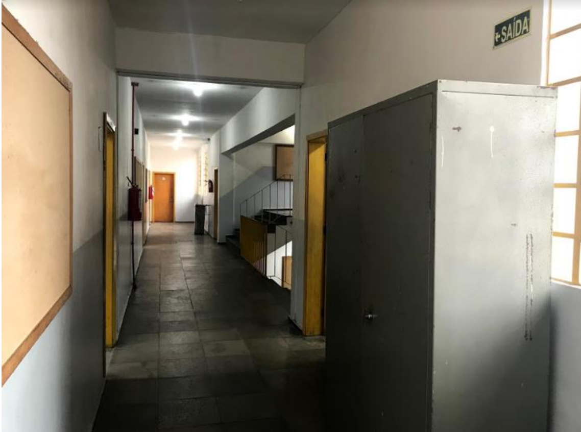
Figura 20 - Perda de largura devido a obstáculos na rota de saída
