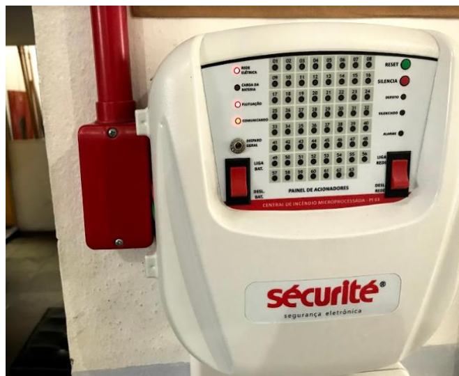
Figura 18 - Sistema de Alarme de Incêndio em funcionamento
