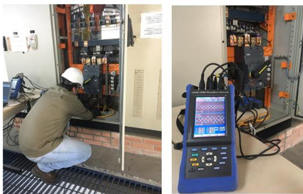
Figura 6 - Instalação do analisador de qualidade de energia elétrica no QGBT
