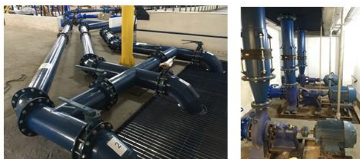
Figura 5 - Barrilete do sistema de bombeamento (esquerda) e conjuntos motobomba (direita)
