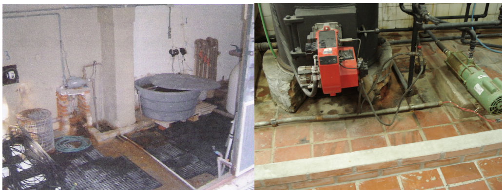
Figura 10: Casa de máquinas.
