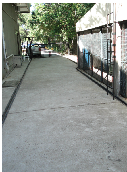
Figura 9: Bacia de contenção do piso do tanque de óleo diesel.
