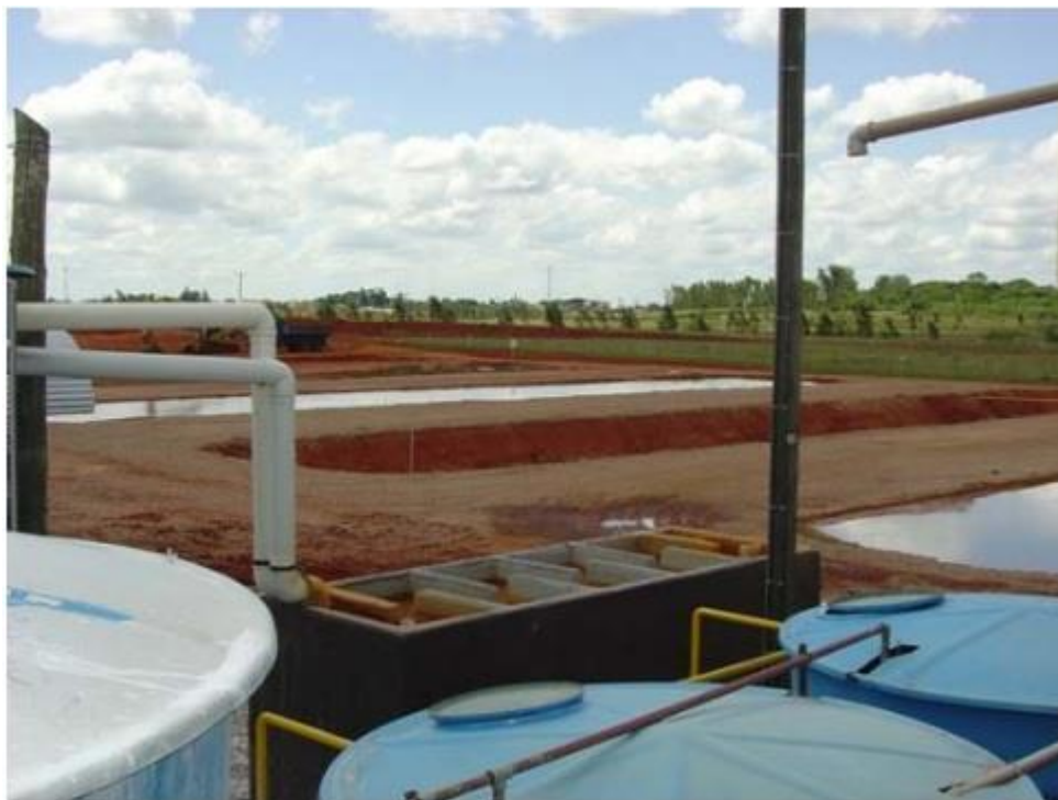
Figura 2. Tratamento ativo de DAM. Bacias de sedimentação de flocos de DAM tratada (via neutralização e floculação) e detalhe do sistema de floculação (chicanas de fluxo hidráulico horizontal) – Capão da Roça, COPELMI/RS.
