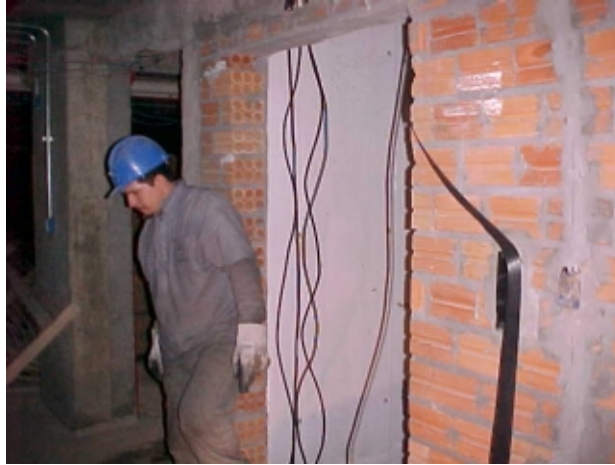
Figura 4.16 - Interferência entre as equipes de instalação elétrica e instalação do elevador
