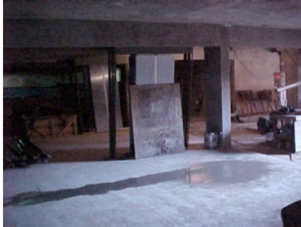
Figura 4.10 - Portas do elevador estocadas ao lado de vazamento de água
