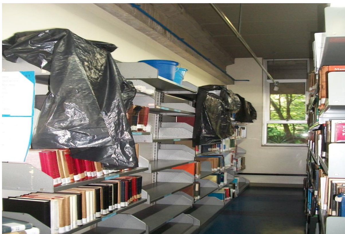
FOTOGRAFIA 3 – Estante atingida por vazamento de um cano na BIBQUI
