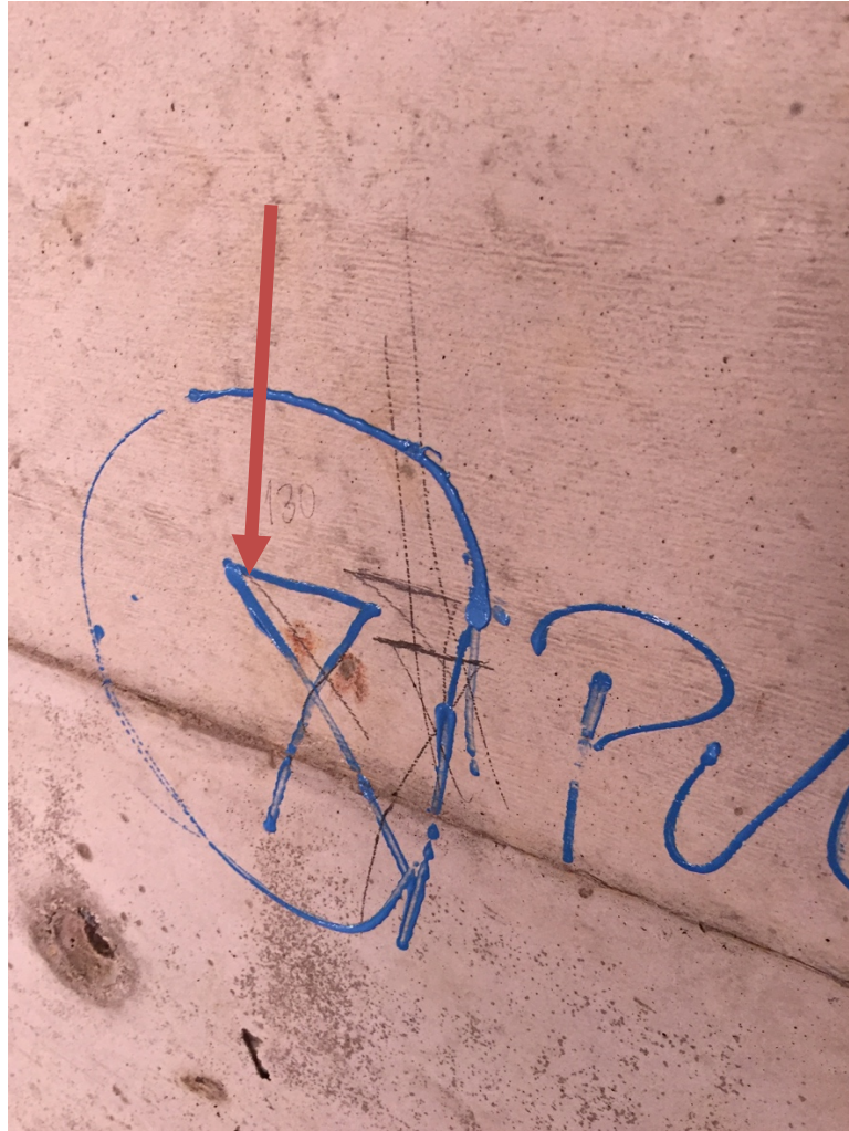
Figura 36 – Marco fixo de referência no pavimento
