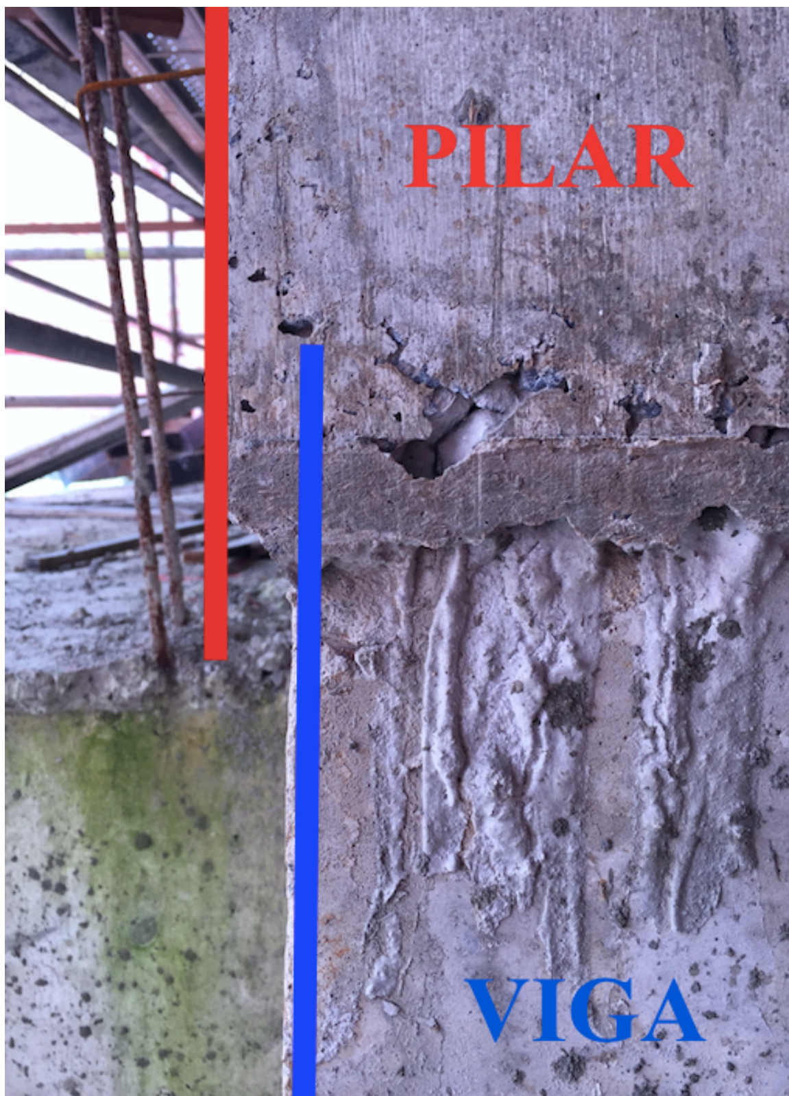
Figura 44 – Descontinuidade entre viga e pilar
