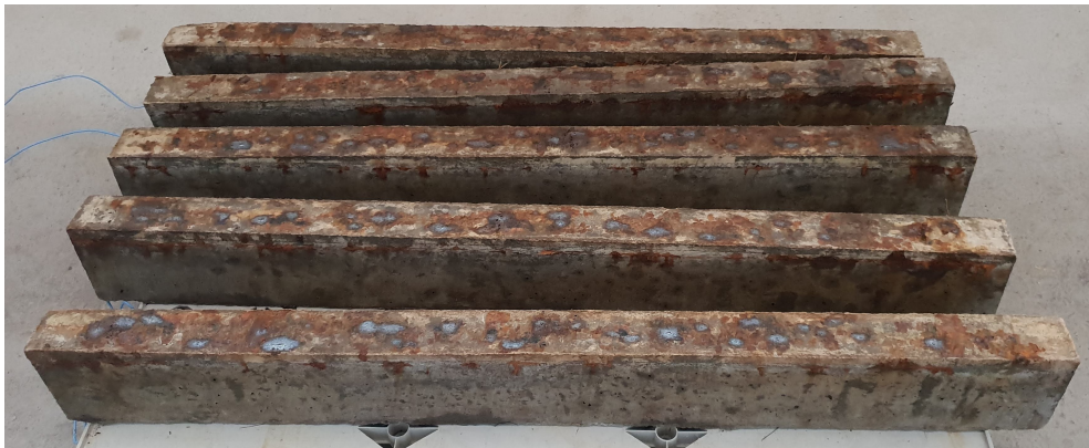
Figura 32 – Face inferior das vigas após a limpeza do produto da corrosão
