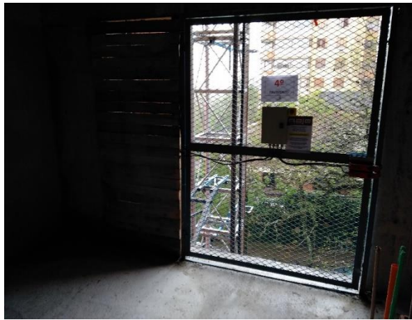
Figura 31 - Local de saída da girica no pavimento
