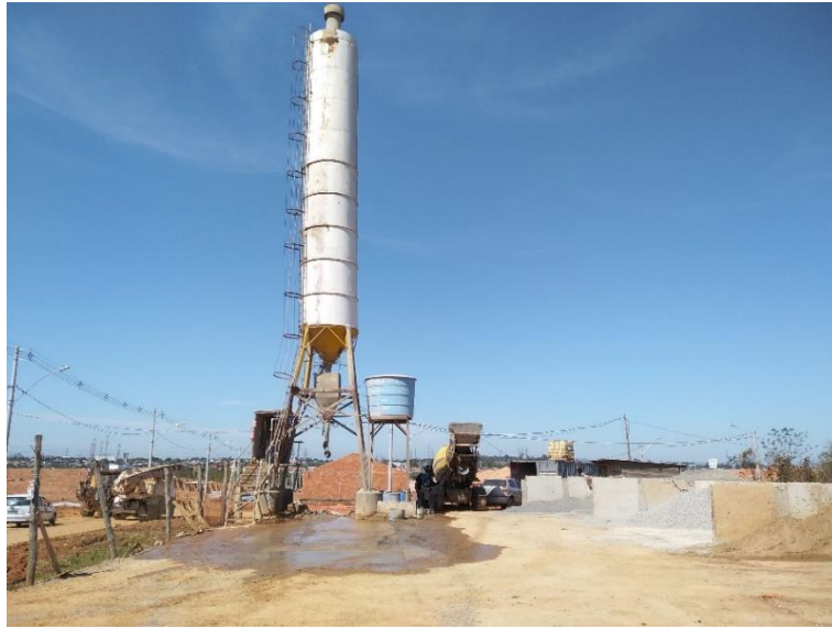
Figura 22 - Central de produção de concreto e argamassa
