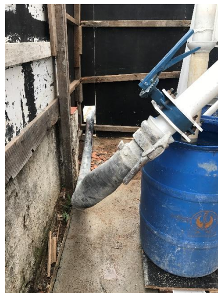
Figura 28 - Abastecimento do silo
