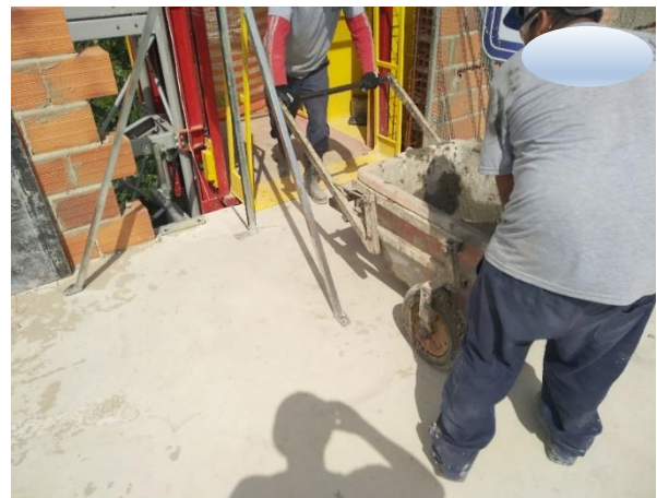
Figura 49 - Saída do acesso do elevador cremalheira
