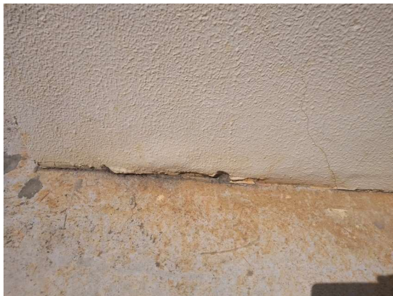
Figura 21 – Ponto de infiltração parede-radier
