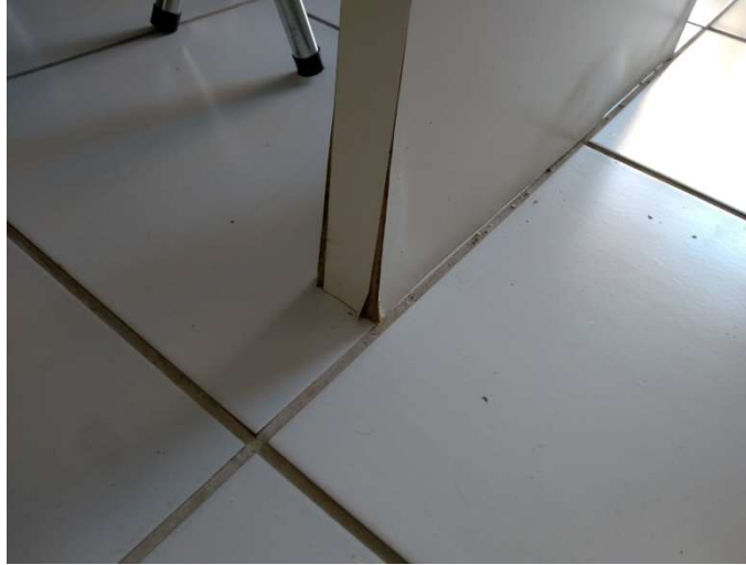
Figura 35 – Presença de umidade no piso cerâmico
