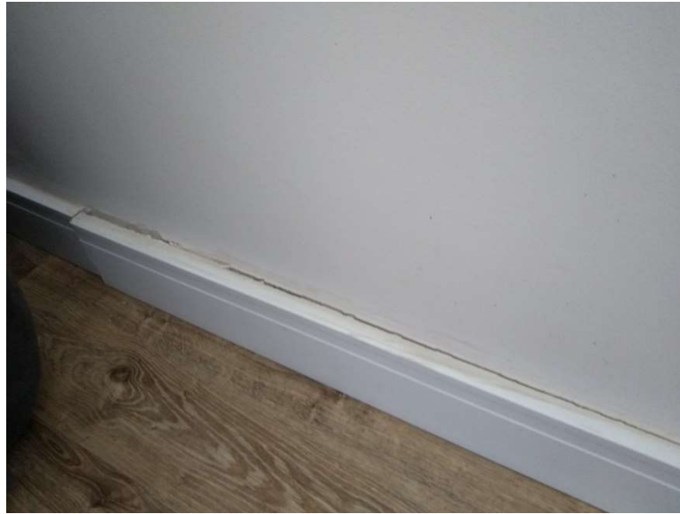
Figura 33 – Presença de umidade acima do rodapé
