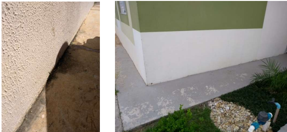
Figura 20A e Figura 20B – Pontos de infiltrações parede-radier
