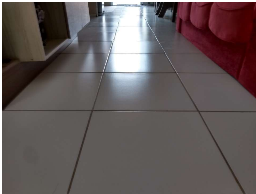
Figura 28 – Desalinhamento e desnível em piso cerâmico
