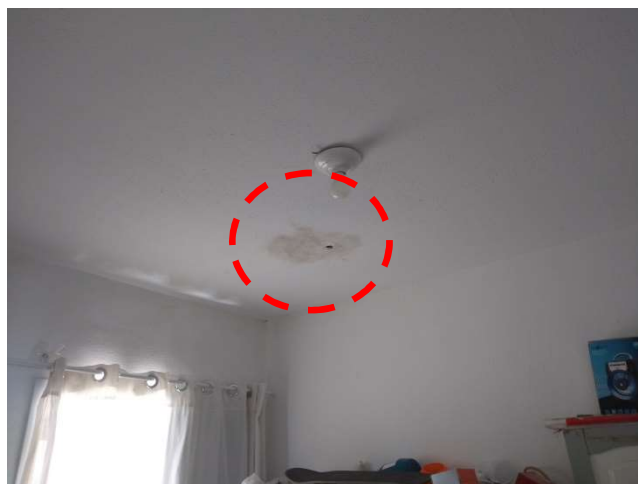
Figura 18 – Ponto de infiltração no dormitório
