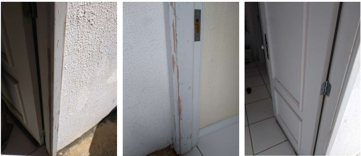
Figura 31A, Figura 31B e Figura 31C – Portas de entrada deterioradas
