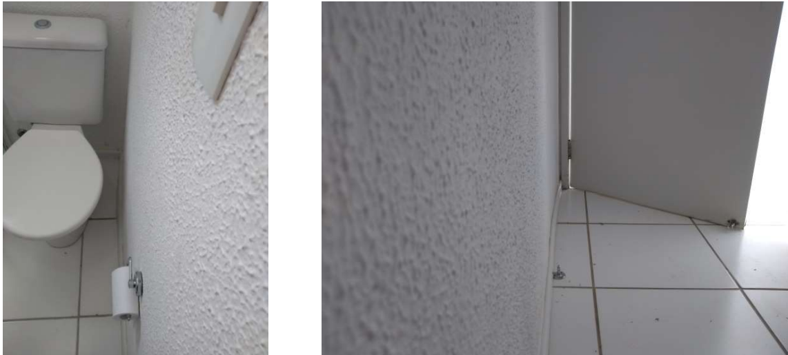
Figura 22A e Figura 22B – Ilustrações de paredes com problemas de alinhamento
