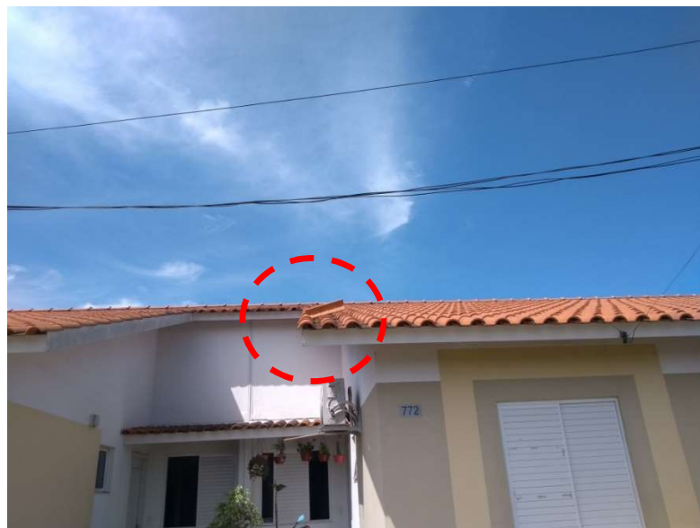
Figura 5 – Desprendimento de telhas pela ação do vento
