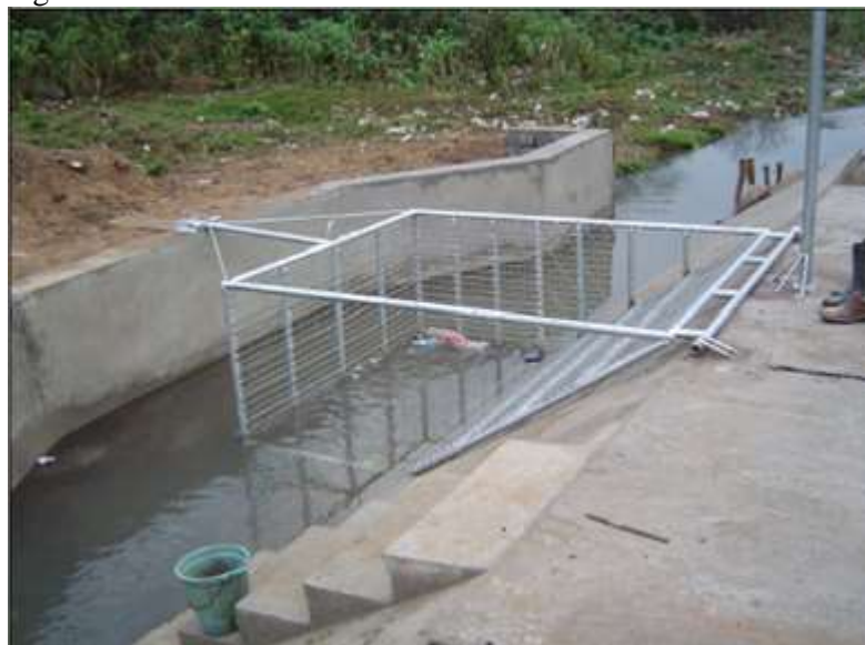
Figura 3 – Armadilha metálica instalada sobre o trecho canalizado.
