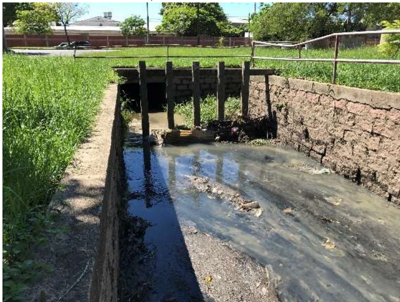
Figura 23 – Estrutura retentora de resíduos no ponto em que o canal da Av. Menna Barreto chega na Av. Sertório, no dia 15 de outubro de 2017.
