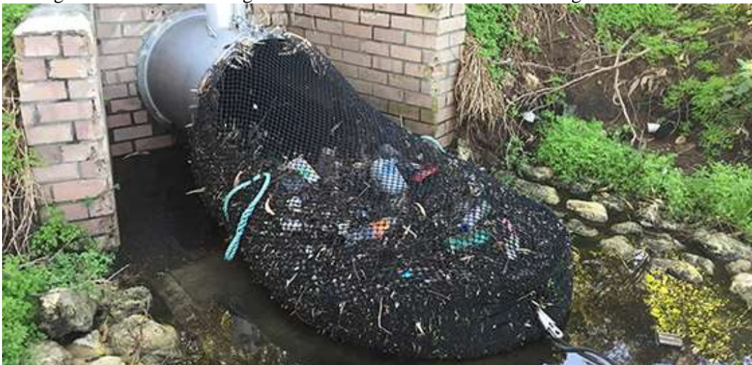
Figura 7 – Redes de filtragem de RS instaladas nos tubos de drenagem em Kwinana.
