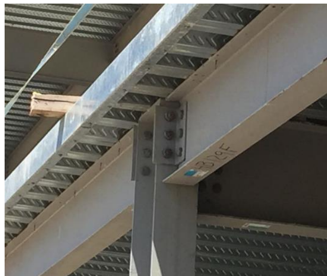
Figura 33 – Ligação pilar-viga com cantoneira devido à restrição geométrica – Estudo de Caso II.
