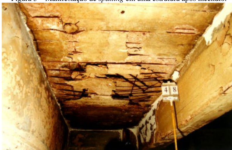
Figura 5 – Manifestação de spalling em uma estrutura após incêndio.
