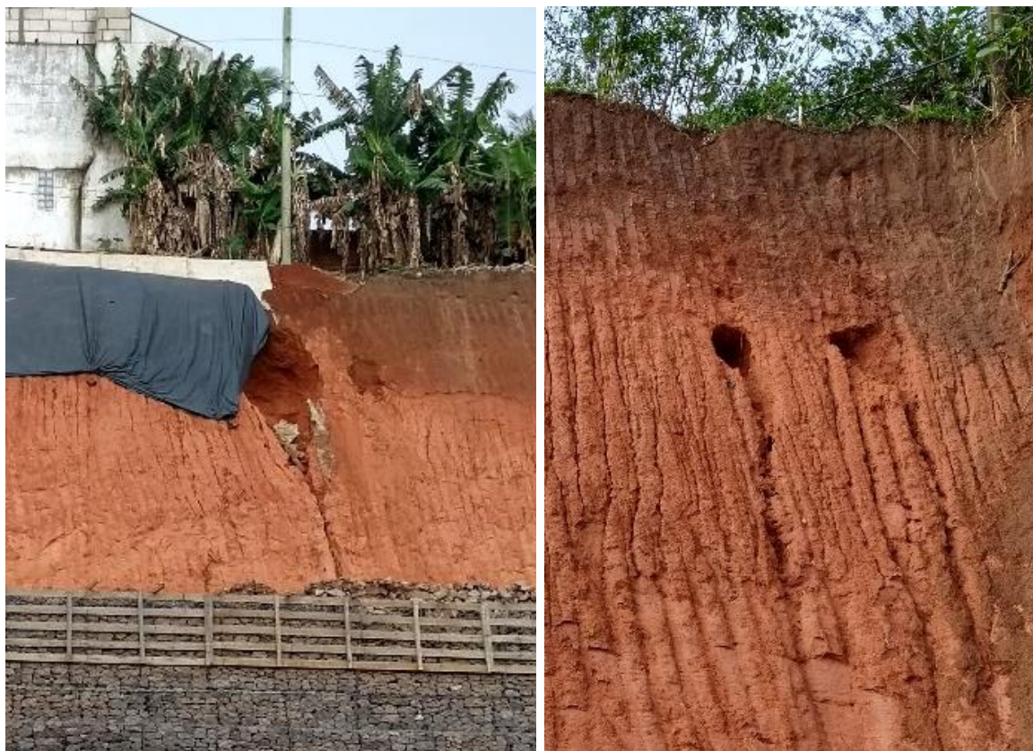
Figura 4 Fotografias de erosões por piping causadas pela circulação de água da perfuração para execução dos tirantes (esquerda) e por infiltração de água de chuva por caminhos preferenciais (direita).
