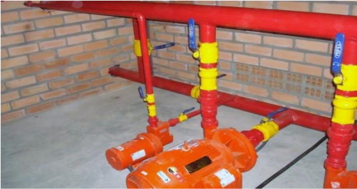
Figura 9– Sistema de bombas
