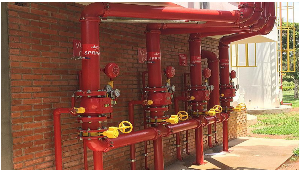
Figura 10– Sistema de controle e alarme
