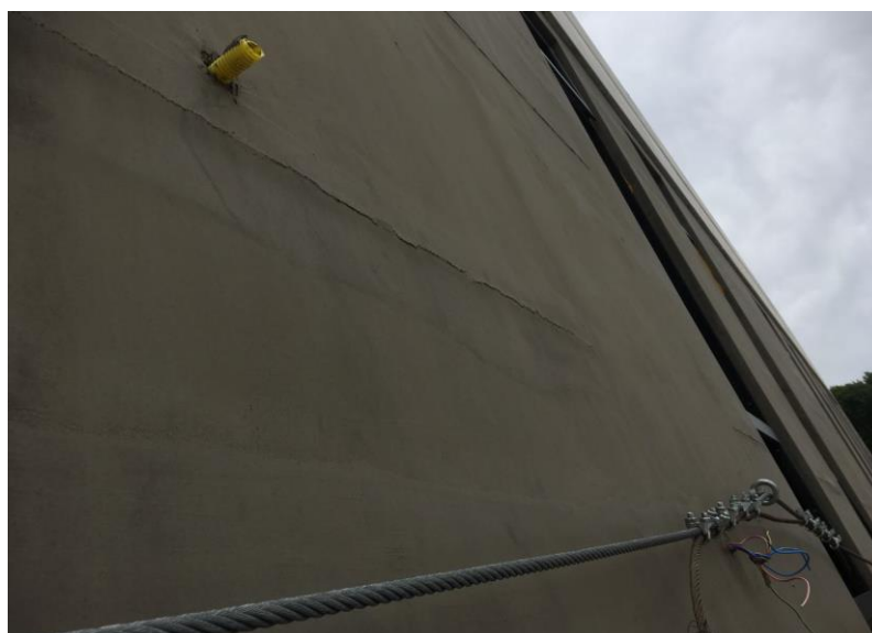
Figura 12 – Manifestação patológica decorrente da sobreposição de juntas das placas OSB e das placas cimentícias
