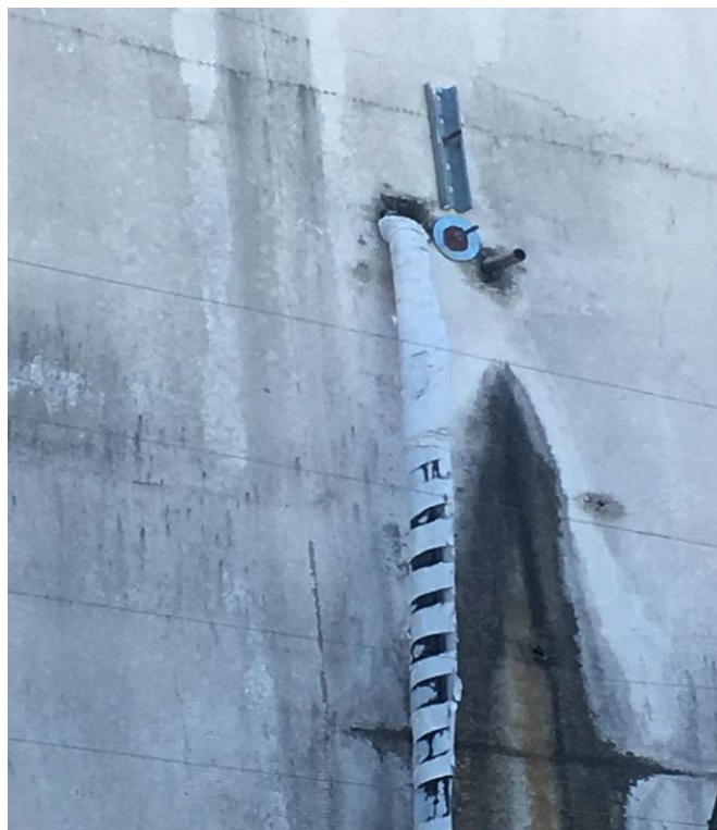
Figura 10 – Manifestação patológica decorrente de interferência entre instalações de refrigeração e revestimento
