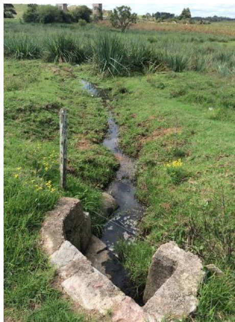
Figura 3 – Banhado contaminado por destinação final ambientalmente inadequada de esgotos domésticos no município de Pedras Altas
