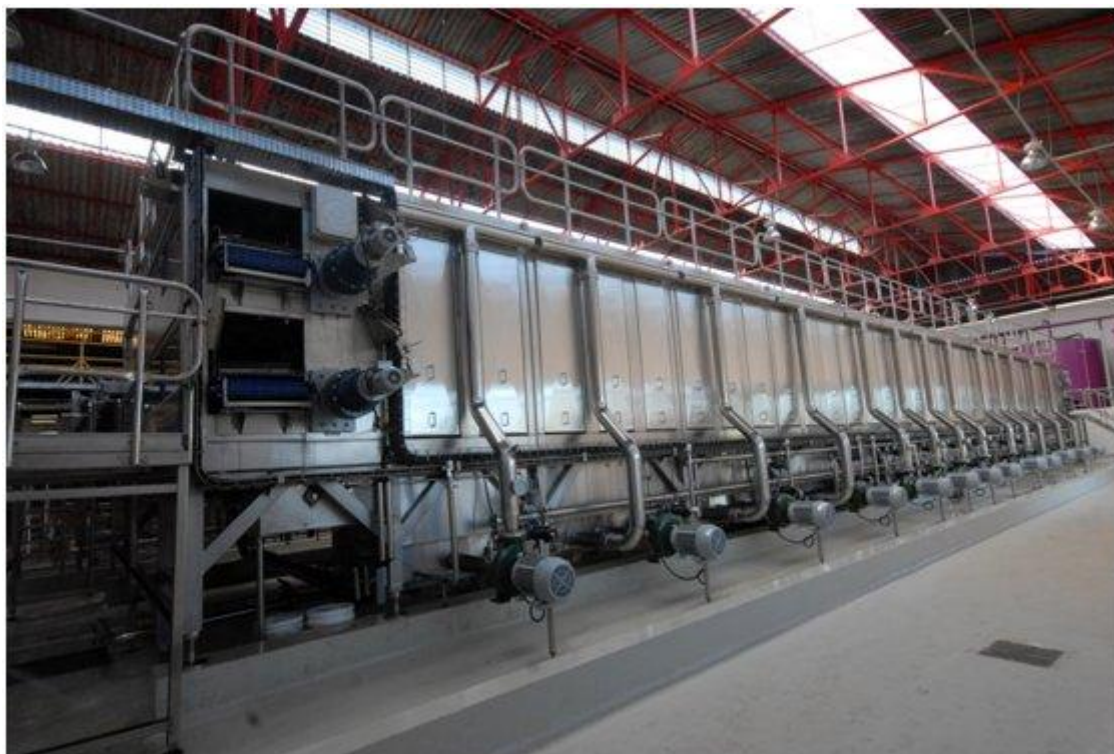
Figura 7.1. Visão geral do túnel pasteurizador nacional com controle de processo.
