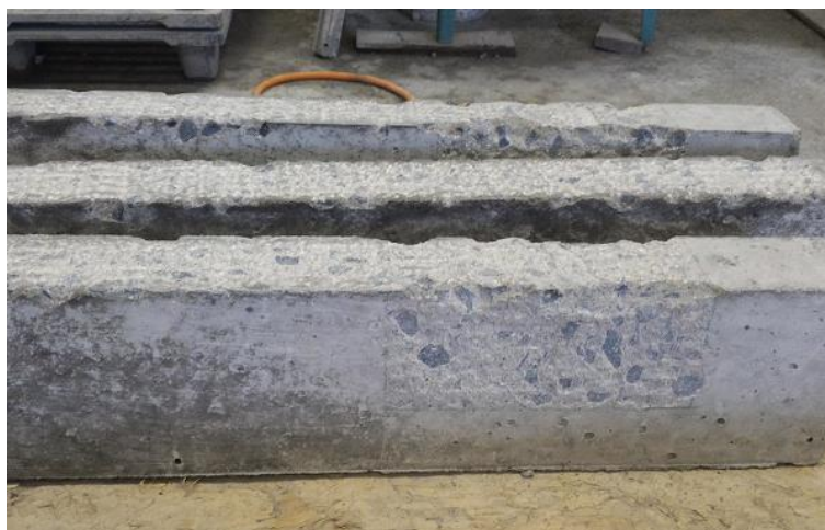
Figura 39: Detalhe da rugosidade da superfície da viga
