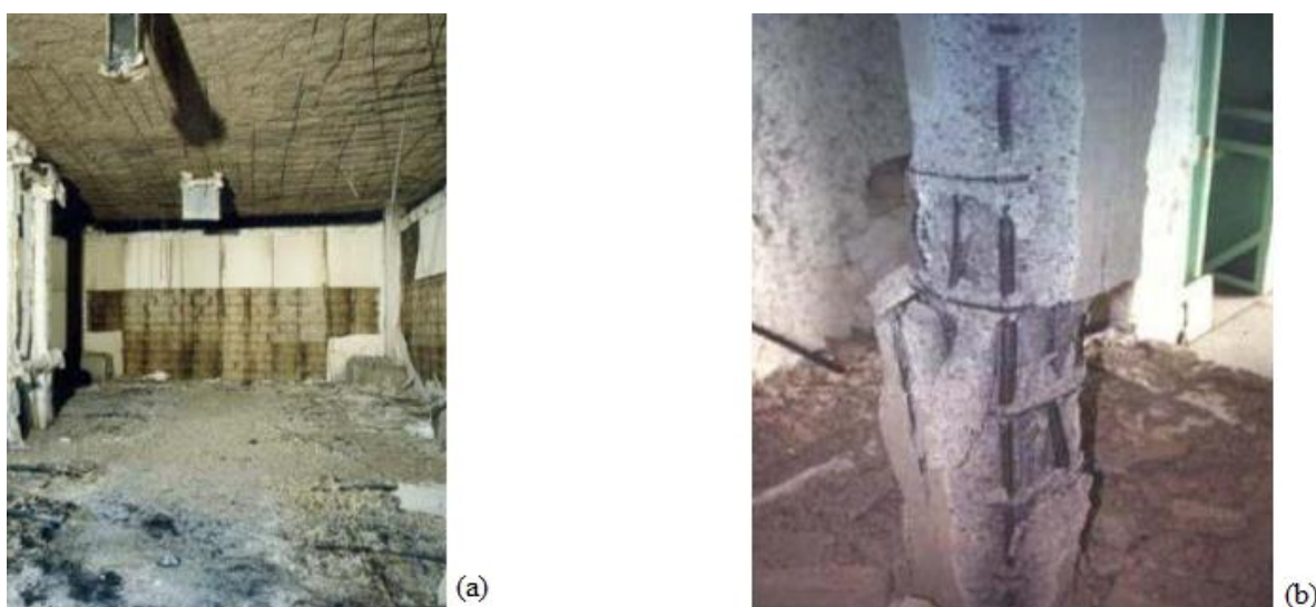
Figura 6 - Exemplos de spalling explosivo após incêndio simulado (a) deslocamento em laje (b) deslocamento em pilar de alto desempenho
