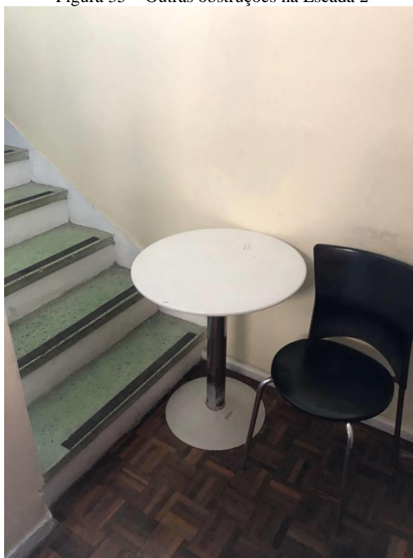
Figura 35 – Outras obstruções na Escada 2
