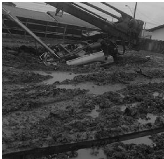
Figura 19 – Problemas na preparação do terreno para o equipamento hélice
