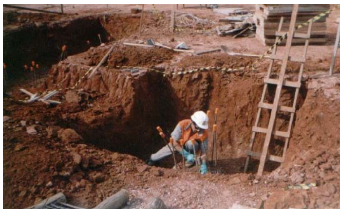
Figura 8.11. Proteções nas pontas verticais de ferragens das estacas.
