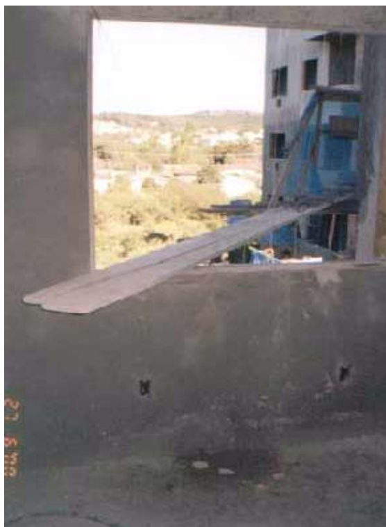
Figura 6.4. Acesso inseguro em andaimes suspensos causado por falta de planejamento.
