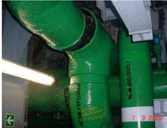
Figura 2.11 Falha na junta de tubulação de PRFV com desalinhamento [11].
