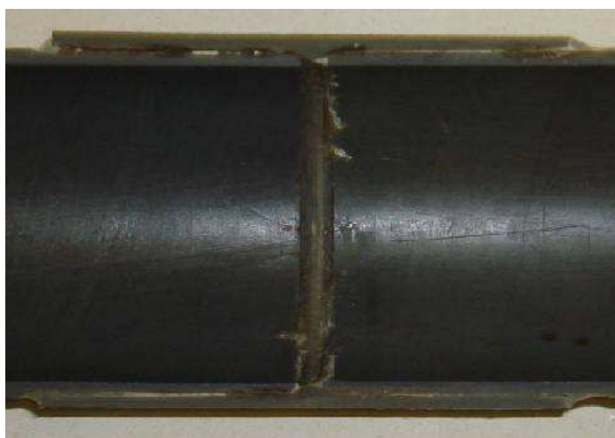
Figura 3.5 Aspecto interno dos tubos e interfaces na junta colada do CP03.
