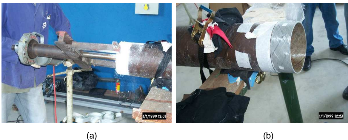
Figura 2.8 Em (a) a usinagem da superfície que ficará em contato com o adesivo para a fabricação da junta colada tipo luva, em tubulação de ERFV. Em (b) a superfície pronta para o processo de aplicação do adesivo [11].
