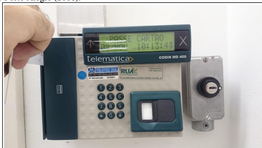
Figura 20 – Acesso magnético por meio de crachá de funcionário autorizado – Hospital de Clínicas de Porto Alegre (2016).
