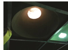
Abertura zenital com fechamento de acrílico
