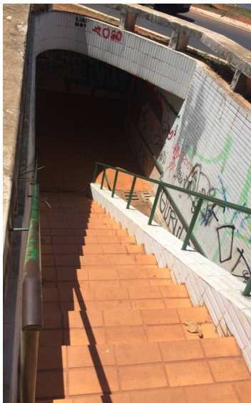
Figura 8 - Acesso à Passagem subterrânea de Brasília na Asa Norte ligando setor 107 ao 207 pelo nível da via
