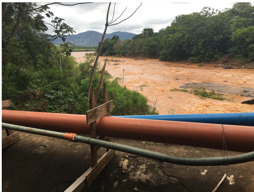
Figura 22 – Tubulações para a canalização da água do Rio Guandu até a estação de captação
